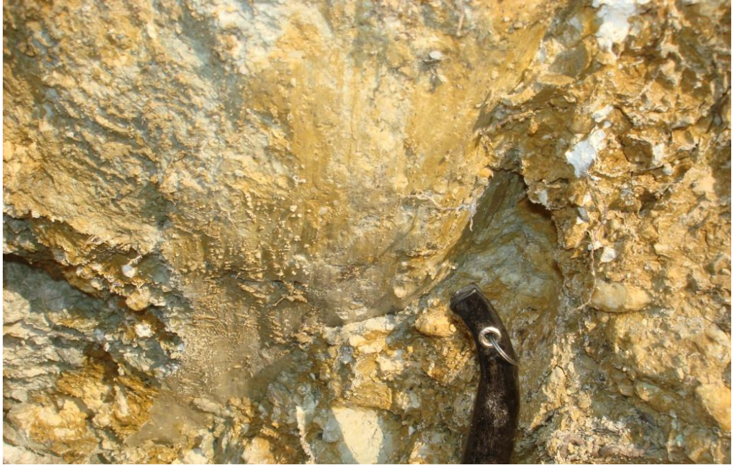
Şekil 24. Akçalar atık depolama sahasından doğuya doğru giden toprak yol üzerinde fabrika inşaatı için açılan temelde gözlenen normal fay düzlemi (Bakış Yönü: Güneydoğu'dan Kuzeybatı'ya; UTM : 35 T 0651136E, 4448154N).
