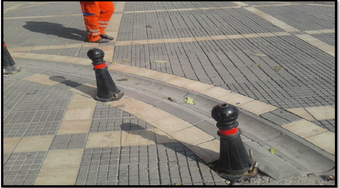
Şekil 3.19: Yeni Cami meydanında hatalı sınır elemanı uygulaması
