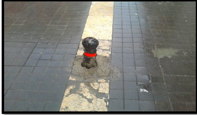
Şekil 3.27: PTT meydanında hatalı sınır elemanı uygulaması.
