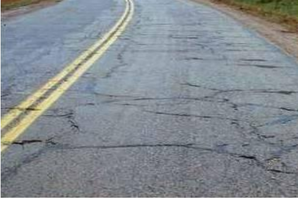
Şekil 5.9 : Büzülme çatlağı görüntüsü
