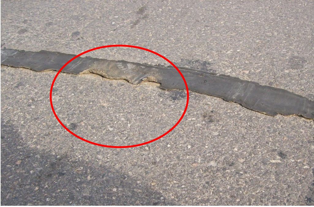
Şekil 6.10 : Yeterli temizlik yapılmaması nedeni ile dolgu malzemesinde bozulma başlangıcı
