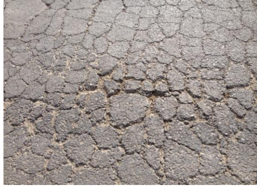
Şekil 5.5 : Timsah sırtı çatlak görüntüsü 2
