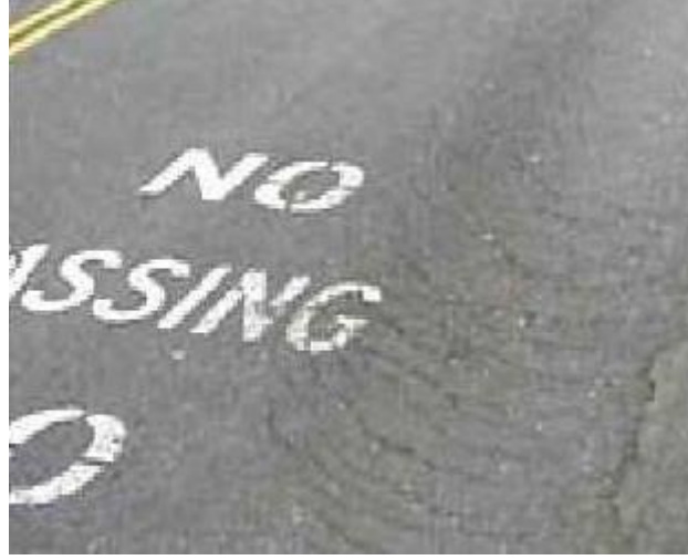
Şekil 5.10 : Kayma çatlağı görüntüsü
