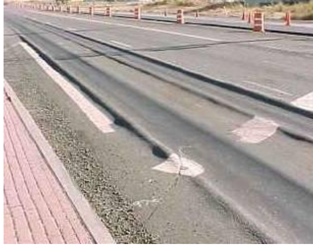
Şekil 5.1 : Asfalt kaplamada tekerlek izi oluşumu
