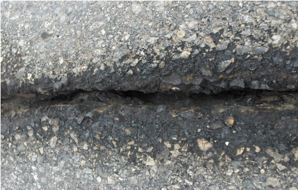
Şekil 6.11 : Kurutma işlemi sırasında kullanılan sıcak havanın mevcut yüzeyle fazla temas etmesi sonucu bitümde meydana gelen bozulma
