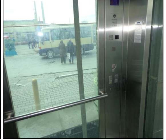
Şekil 5.32: Asansör Kontrol Paneli
