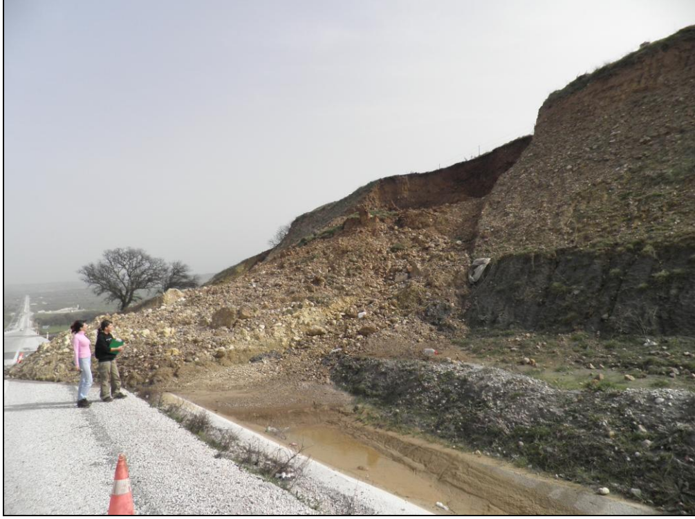
Şekil 4.12. Bursa – İzmir Karayolu üzerindeki heyelandan bir görünüm (GPS:, 35 S 4445061 E / 455057 N; Bakış Yönü, Güney'den, Kuzeye).
