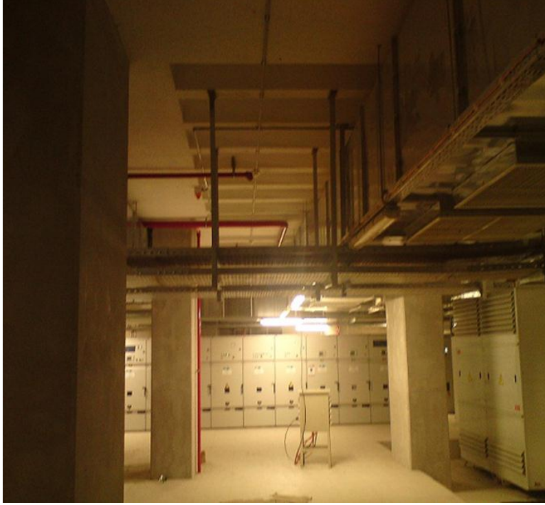
Şekil 5. 17: Cer, trafo odası görünüşü
