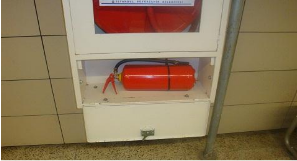
Şekil 5. 19: Yangın söndürme tüpü ve yangın dolabı
