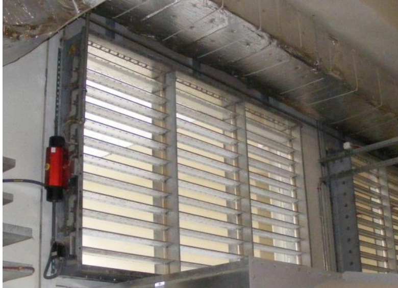
Şekil 5. 25: Aktuatör ve by-pass damperleri
