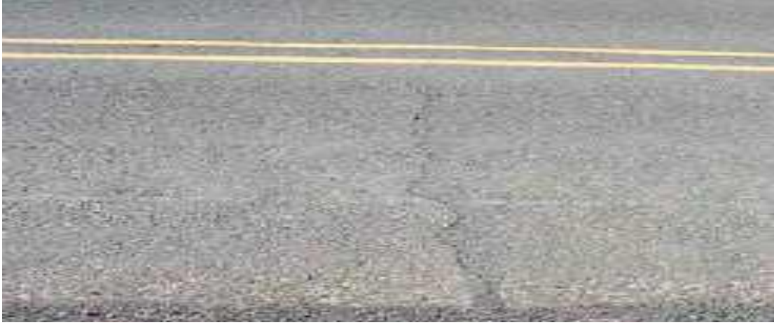
řekil 4.4 : Enine çatlak
