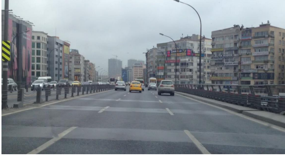
Şekil 7.8 : D-100 Karayolu bozulma örneği 6
