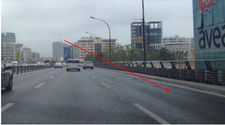
Şekil 7.9: D-100 Karayolu bozulma örneği 7
