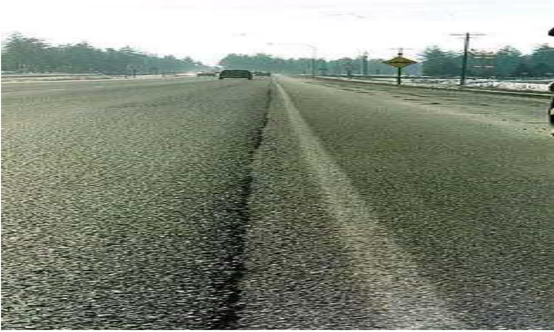
Şekil 4.5 : Yüksek şiddette boyuna çatlak
