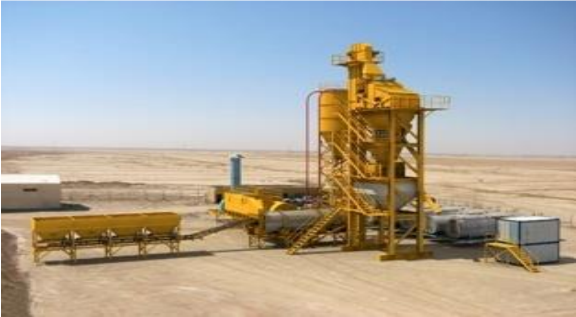
Şekil 3.2 : Drum-Mix tipi asfalt planti
