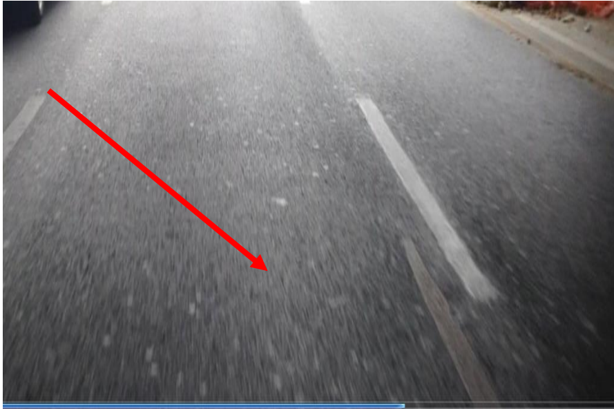
Şekil 7.7 : D-100 Karayolu bozulma örneği 5
