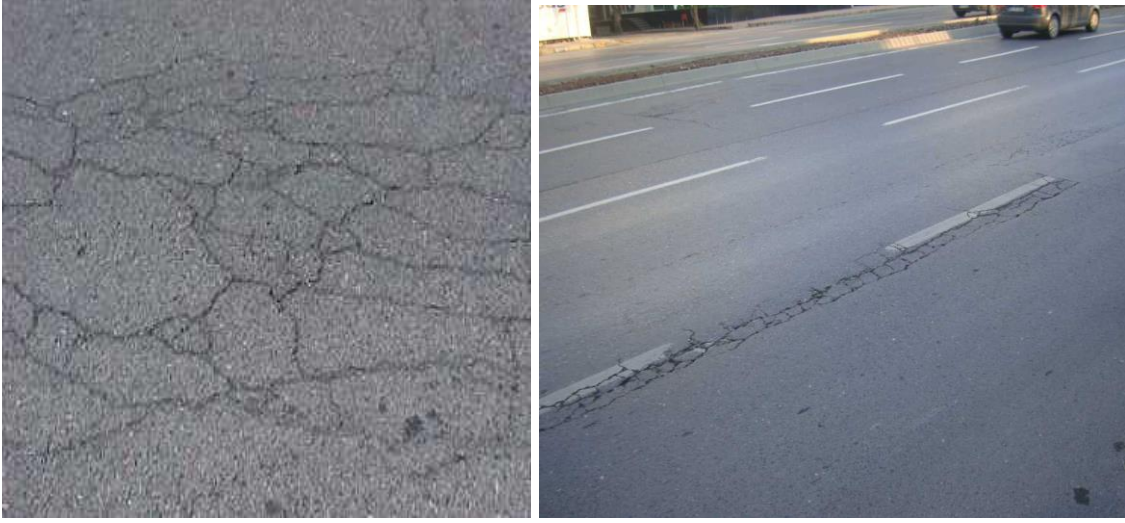
Şekil 4.2 : Timsah sırtı çatlak
