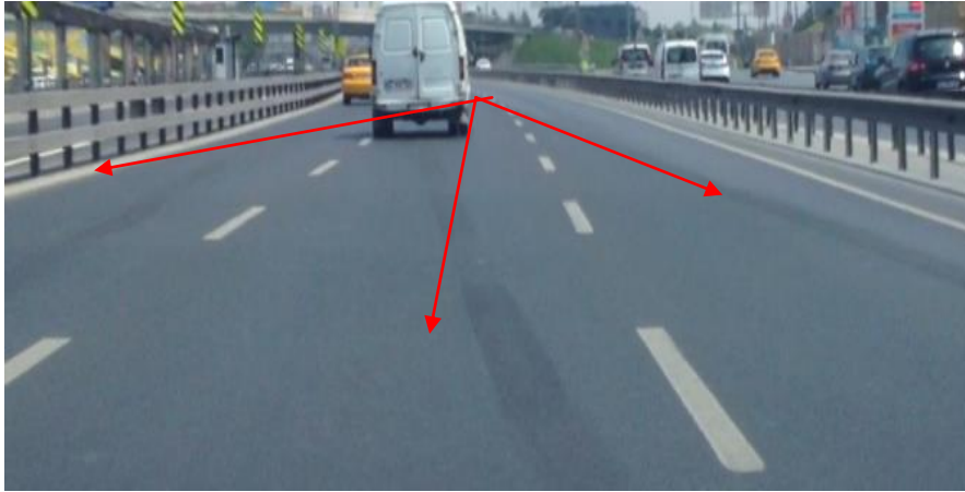
Şekil 7.5 : D-100 Karayolu bozulma örneği 3
