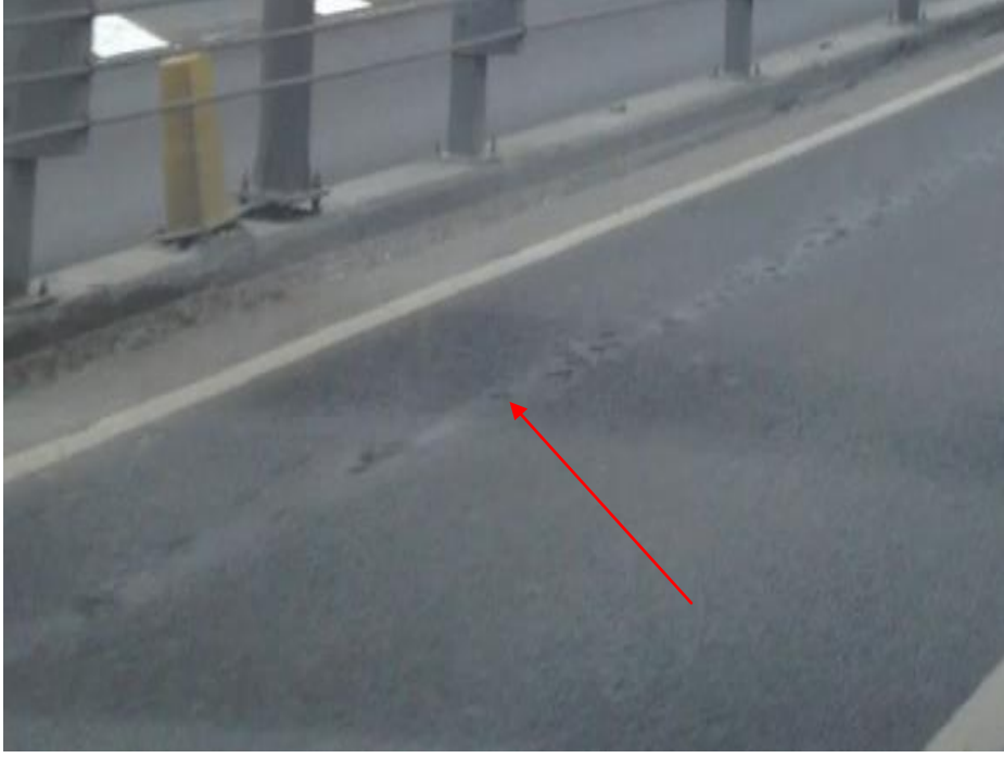
Şekil 7.6 : D-100 Karayolu bozulma örneği 4
