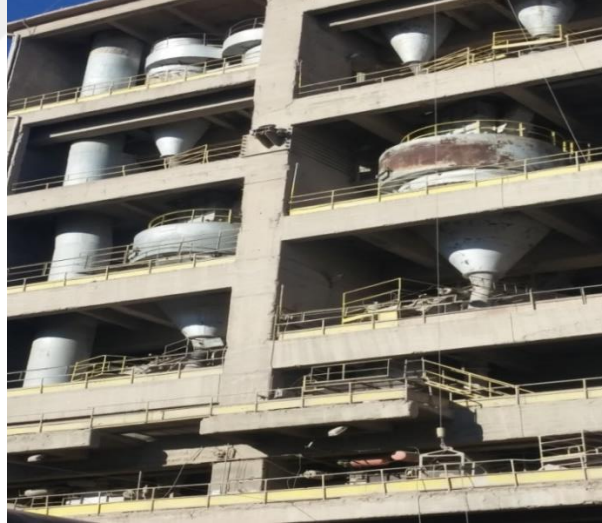
Şekil 3.12 Siklon katı bölümünün genel görünümü.
