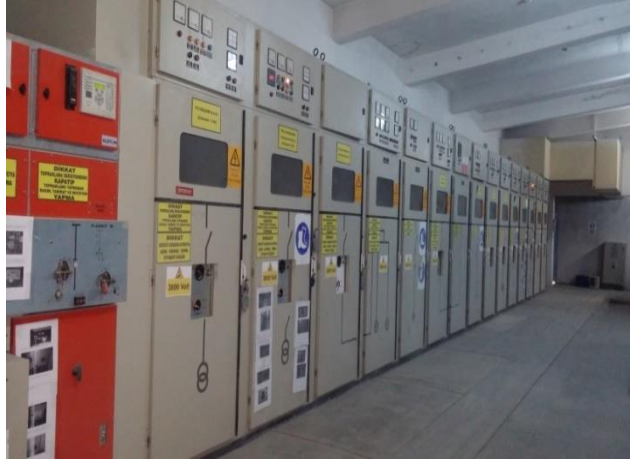
Şekil 3.8 Elektrik bakım bölümü genel görünümü.
