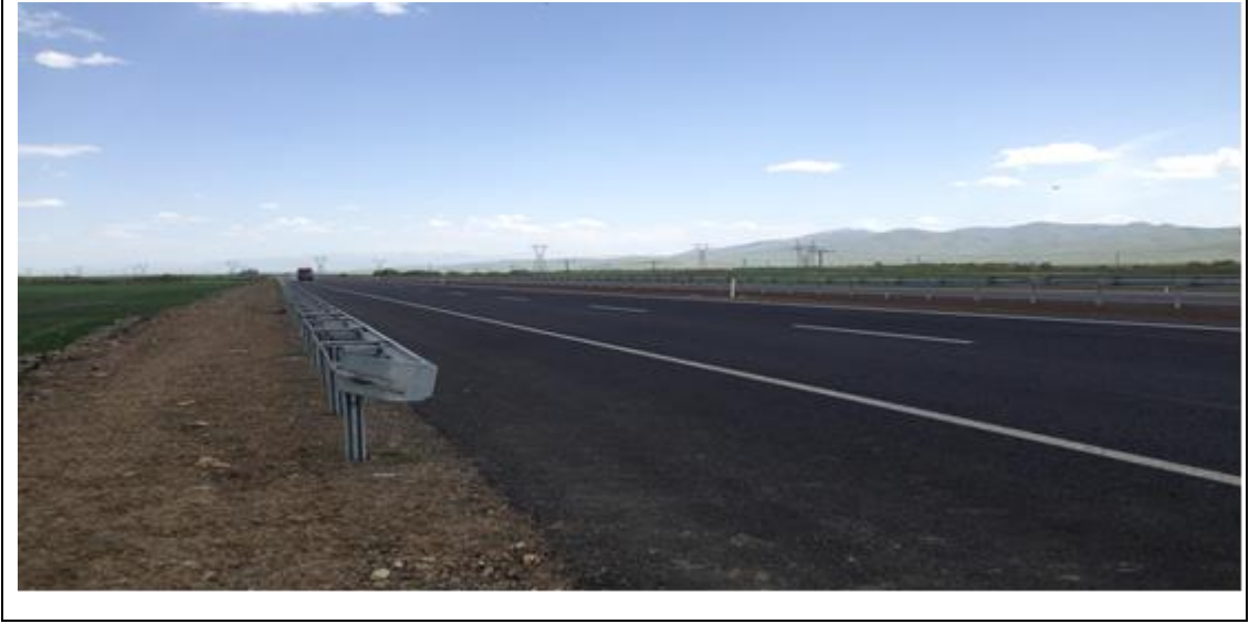
Şekil 2.16: Uç parçası havada bırakılmış ve araç çarpması sonucu aracın otokorkuluk sistemine saplanma riski yüksek olan hatalı otokorkuluk sistemi
