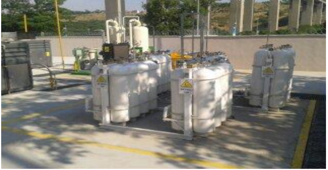
Şekil 4.7: Kağıthane garajında bulunan depolama tankları
