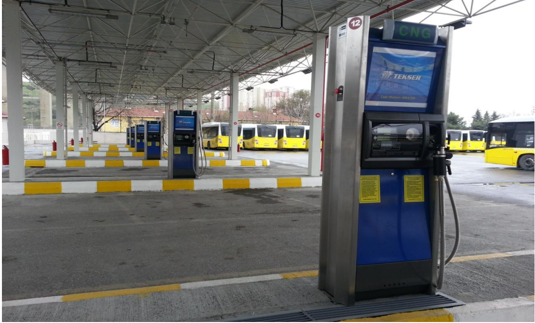
Şekil 4.9: Kağıthane garajında bulunan dispanserler
