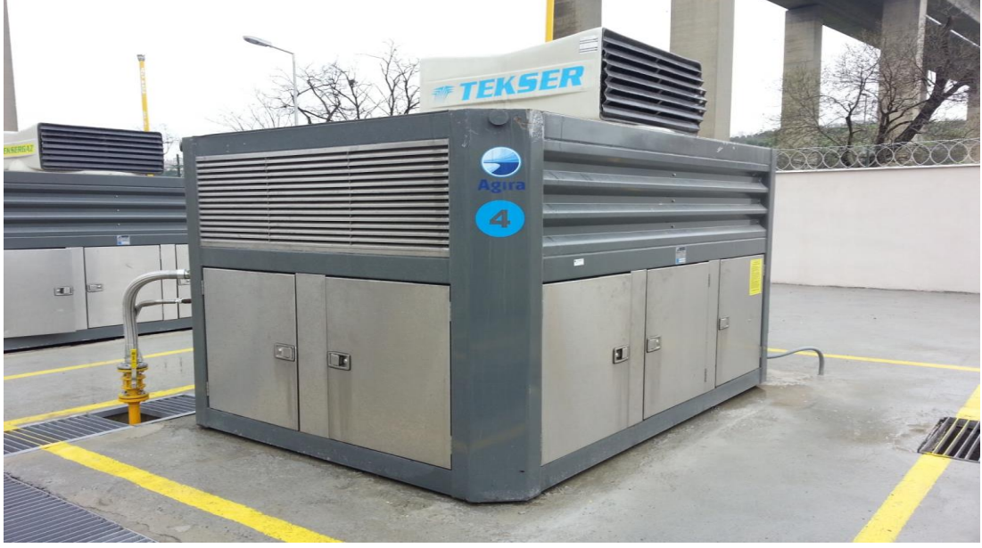
Şekil 4.8: Kağıthane garajında bulunan kompresörler
