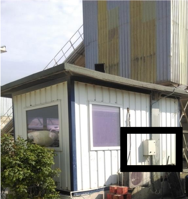
Şekil 5.7. Santral odasındaki elektrik panosu
