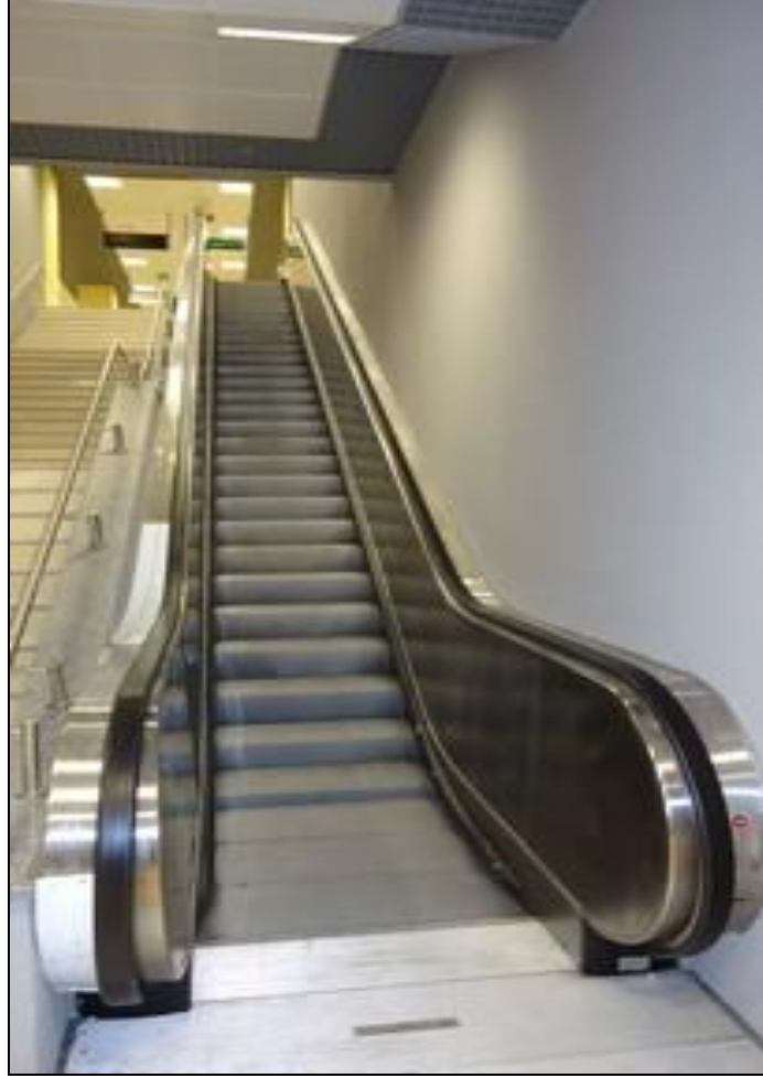
Şekil 6.2: M3 Metro hattı istasyonlarında bulunan yürüyen merdivenlerden biri
