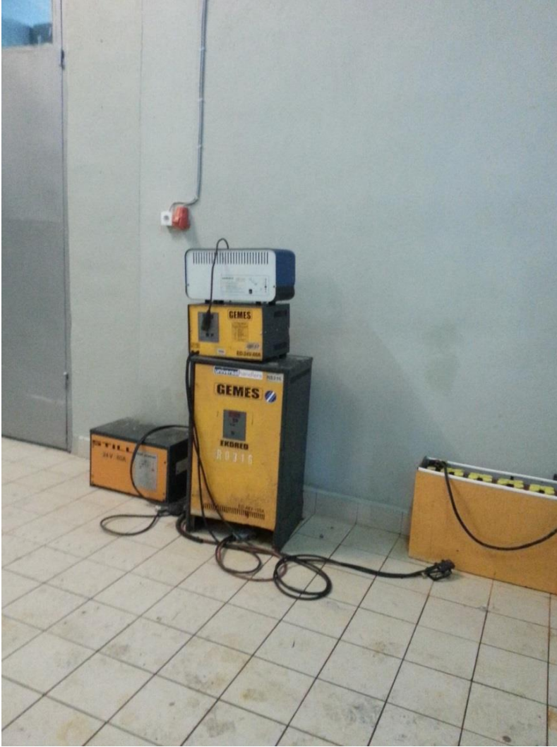
Şekil 4.5. Şaraphane bölümündeki forkliftin uygun olmayan akü şarj etme yeri
