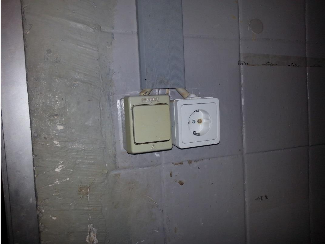
Şekil 4.4. Şaraphane bölümündeki kimyasal depo alanında hasarlı (yanmış) priz
