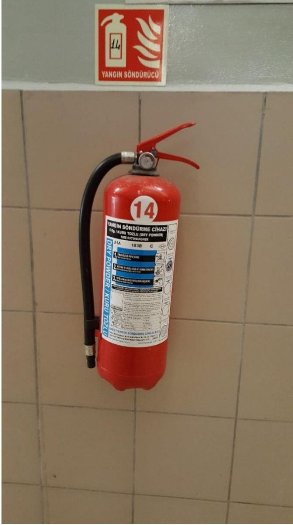
Şekil 5.25. Bakımı yapılan yangın tüpleri
