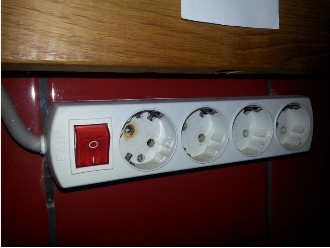
Şekil 4.18. Restorantta bulunan hasarlı priz
