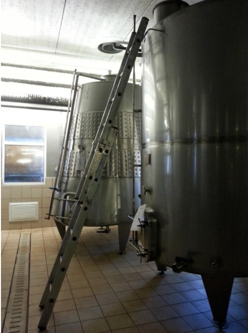
Şekil 4.3. Şaraphane bölümü uygun olmayan el merdiveni
