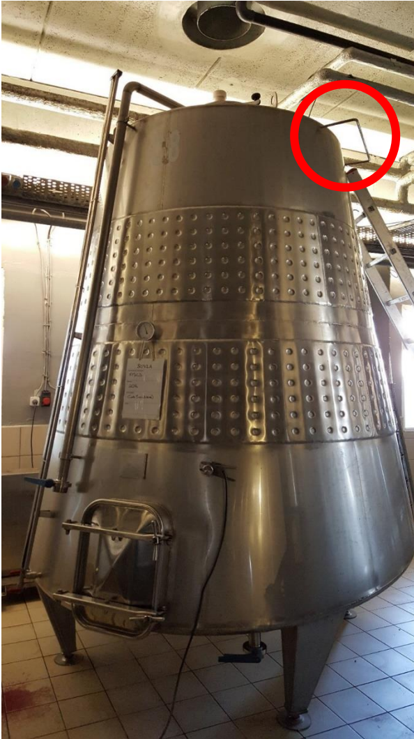
Şekil 4.7. Tankların üzerinde bulunan uygun olmayan merdiven asma aparatı
