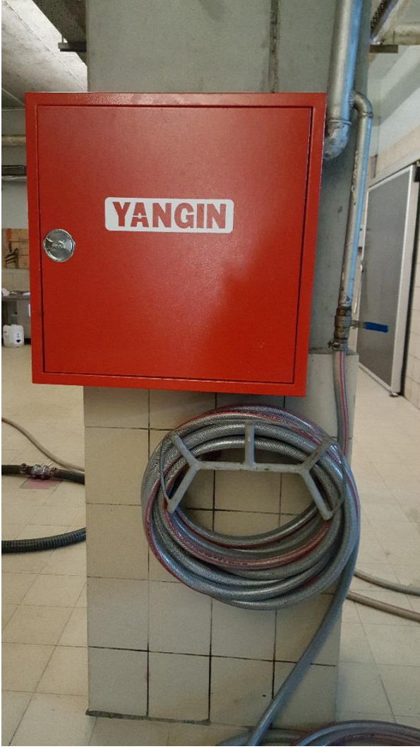
Şekil 5.24. Yenilenen yangın dolapları
