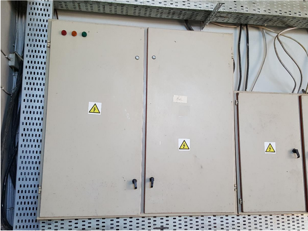
Şekil 5.27. Kapakları kapalı elektrik panoları
