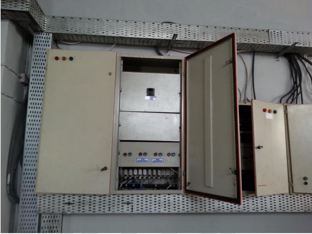
Şekil 4.22. Kapakları açık olan elektrik panoları
