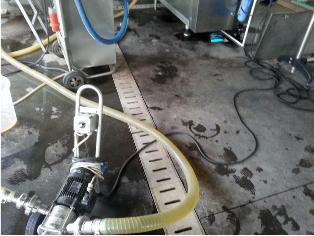
Şekil 4.16. Şişeleme hattındaki dağınık elektrik kabloları
