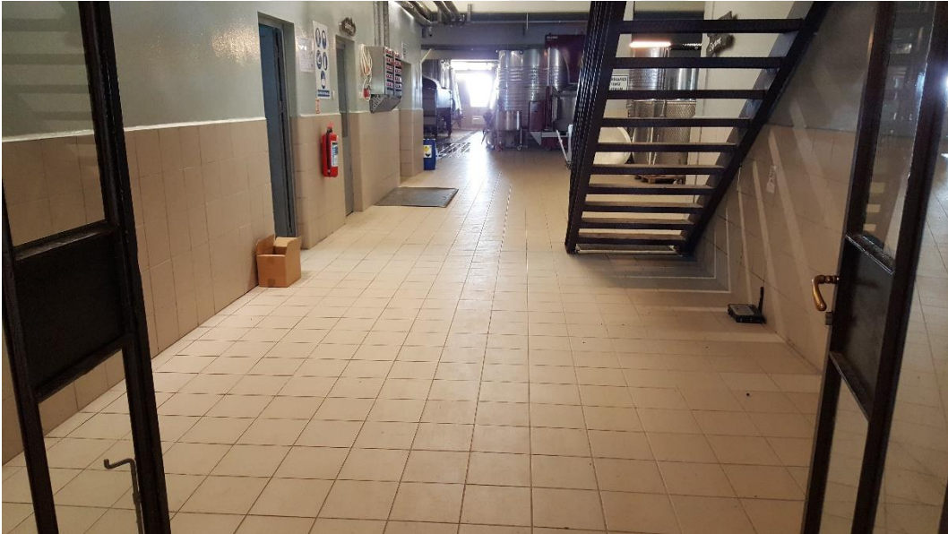
Şekil 4.2. Şaraphane bölümü kaygan zemin
