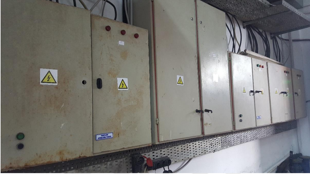
Şekil 5.26. Uyarı işaretleri yapıştırılmış elektrik panoları
