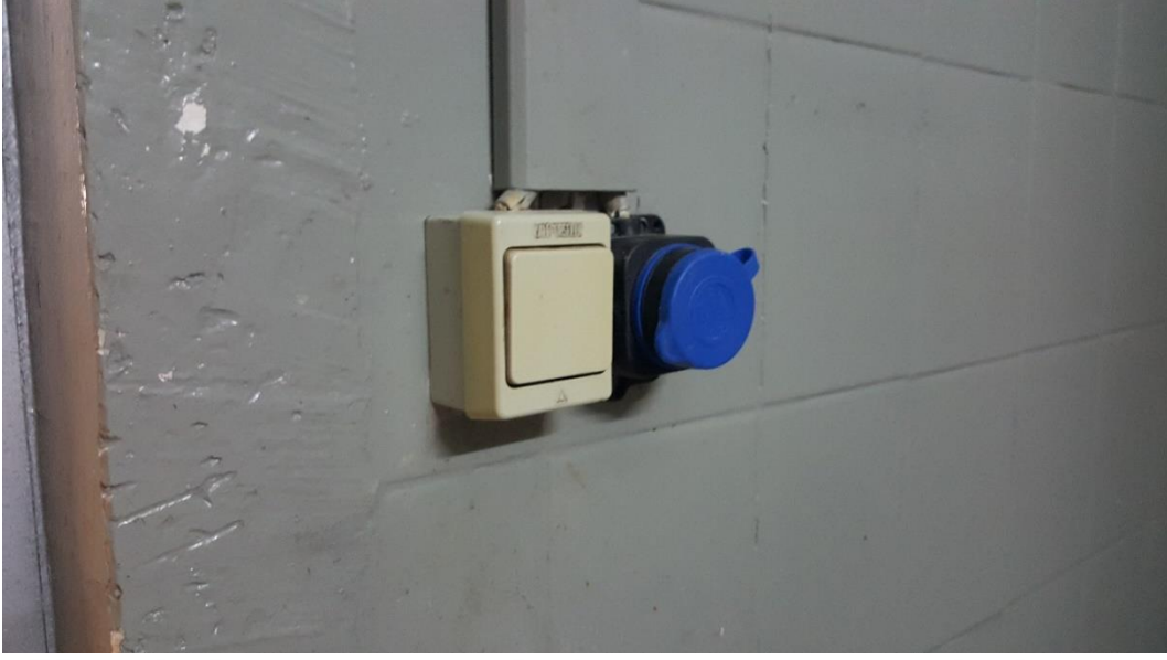
Şekil 5.15. Şaraphane bölümündeki depoda yenilenen priz
