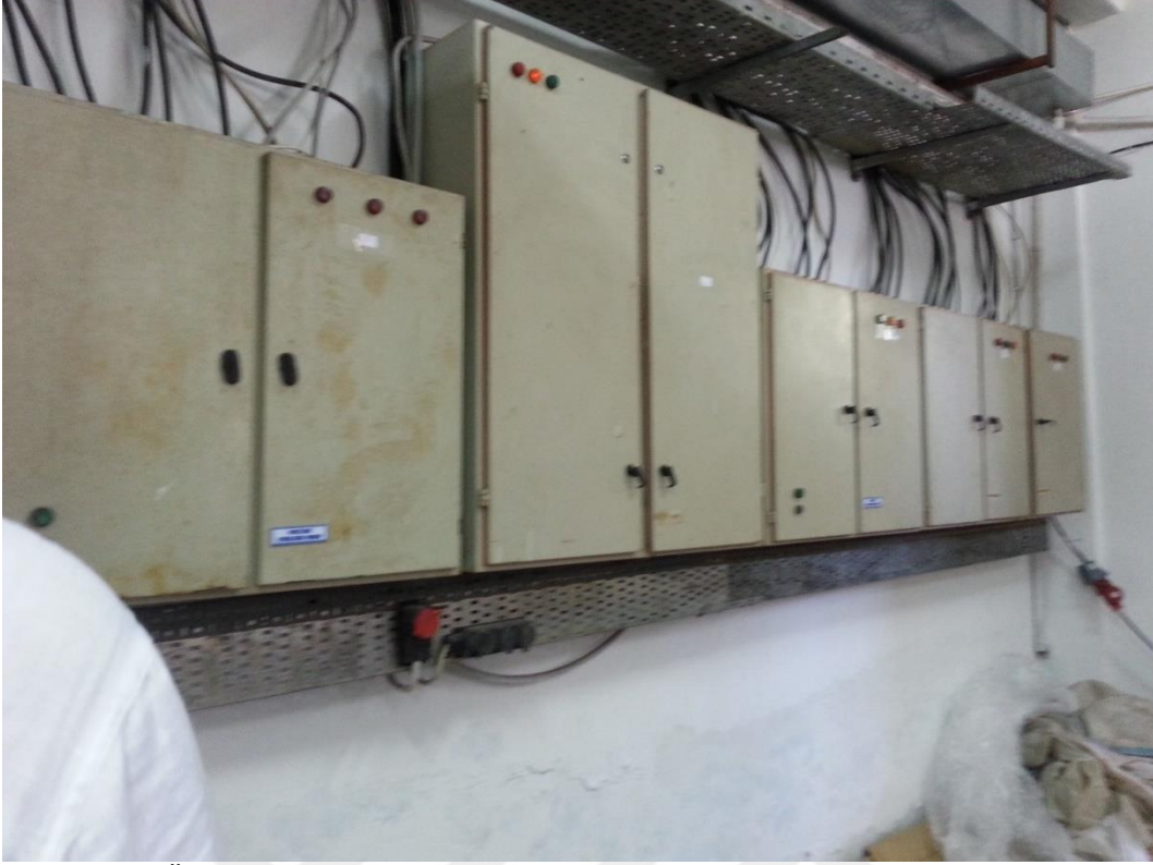
Şekil 4.23. Üzerinde uyarı işaretleri olmayan elektrik panoları
