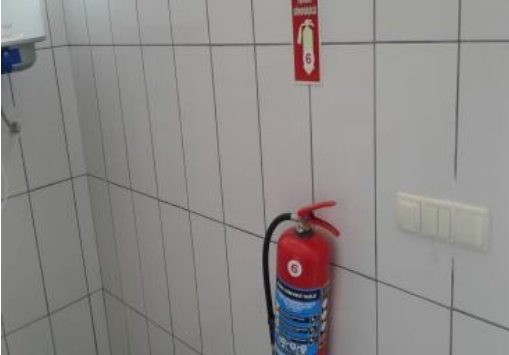
6.b. Yangın söndürücülerin kolay fark edilebilir şekilde muhafaza edilmesi
