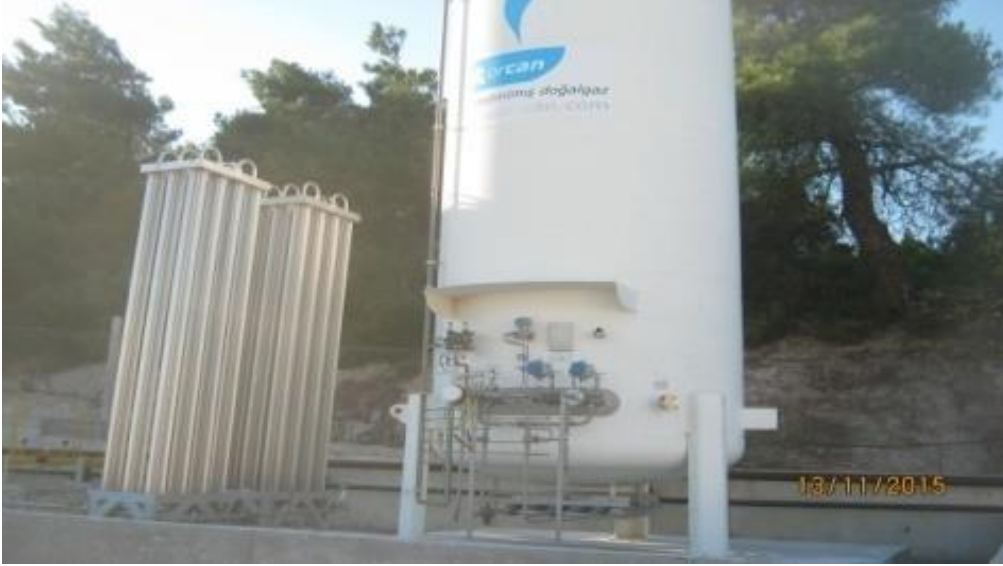
3.a. Gaz tankının etrafının korunmasız olması
