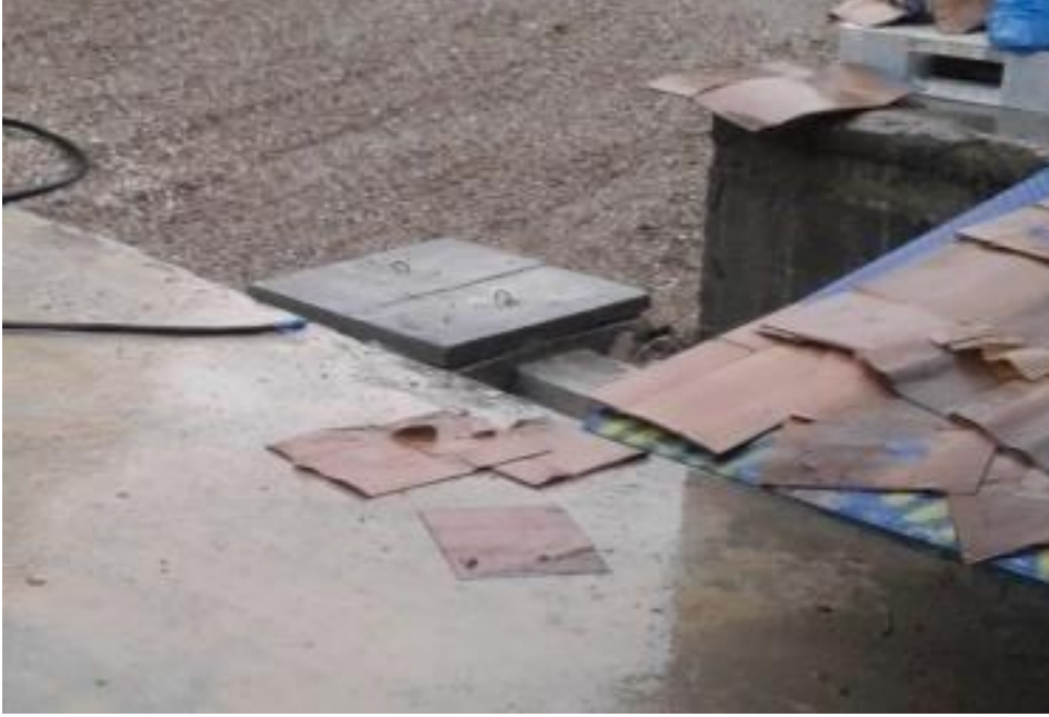
5.b. Fabrika içerisindeki düşülebilir boşlukların kapatılması
