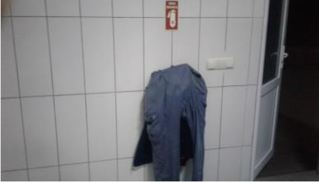
6.a. Yangın söndürücülerin farkedilmeyecek şekilde önünün kapatılması
