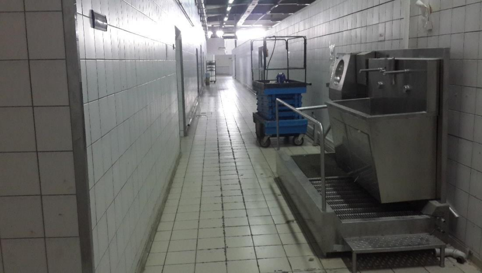
10. Acil çıkış güzergâhında gereksiz malzeme bulunması, hasar görmüş zeminler.
