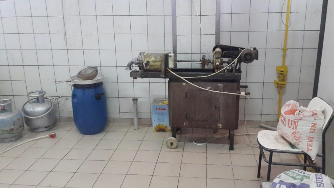
2. Döner aksamların koruma altında olmaması, lpg tüplerinin bina dışına alınmaması ve korunmasız olması.
