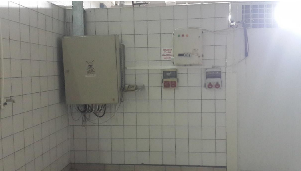
12. Elektrik panolarında gerekli talimat, uyarı ve yalıtkan levhaların bulunmaması.
