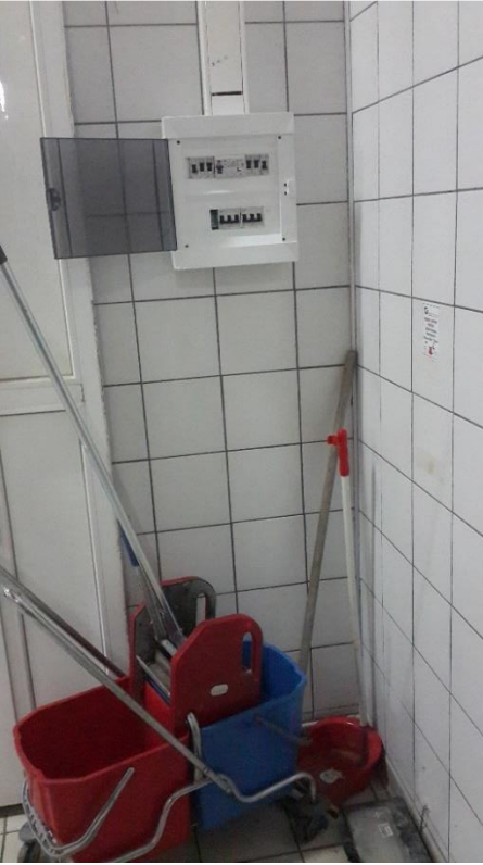
4. Elektrik panolarında uyarı levha ve talimatların bulunmaması, acil durumda eriřimin engellenmesi.
