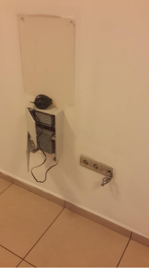
11. Elektrik ve telefon santrali tesisatlarının emniyetsiz şekilde bulundurulması.
