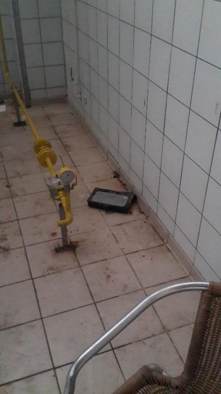
6. Kullanılmayan doğalgaz tesisatının kör tapa ile kapatılmaması, uyarıcı levhaların bulunmaması, haşere ilaçlarına karşı koruyucu tedbirlerin alınmaması.
