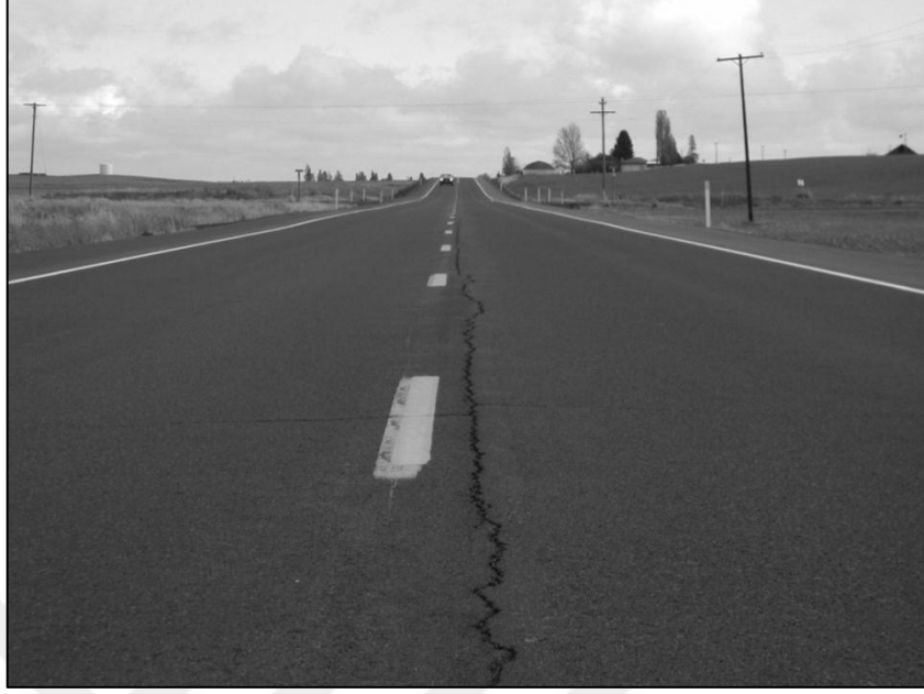
Şekil 2.11: Boyuna çatlaklara örnek
