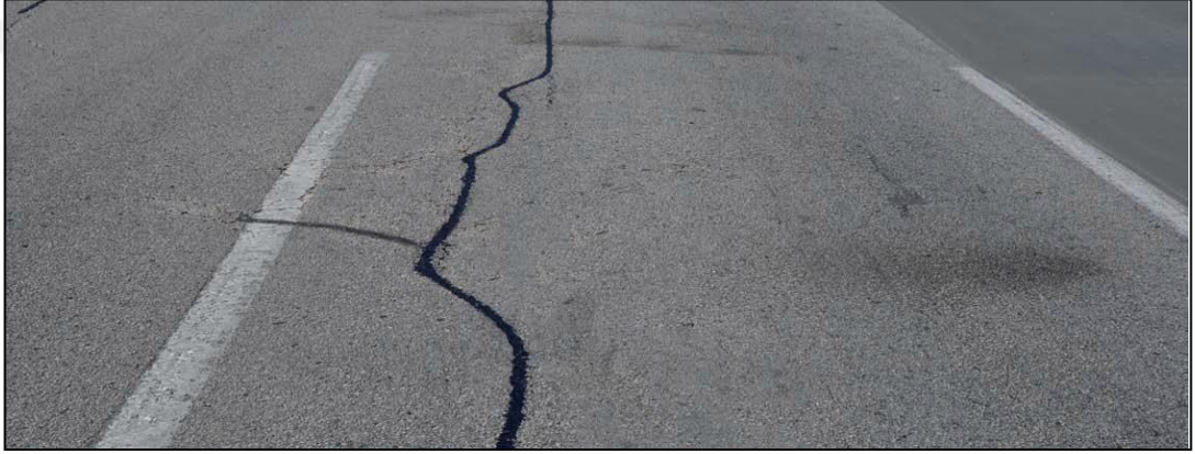
Şekil 2.18: Çatlak dolguya örnek
