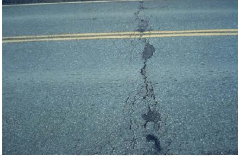
Şekil 2.9: Enine (Termal) çatlaklara örnek
