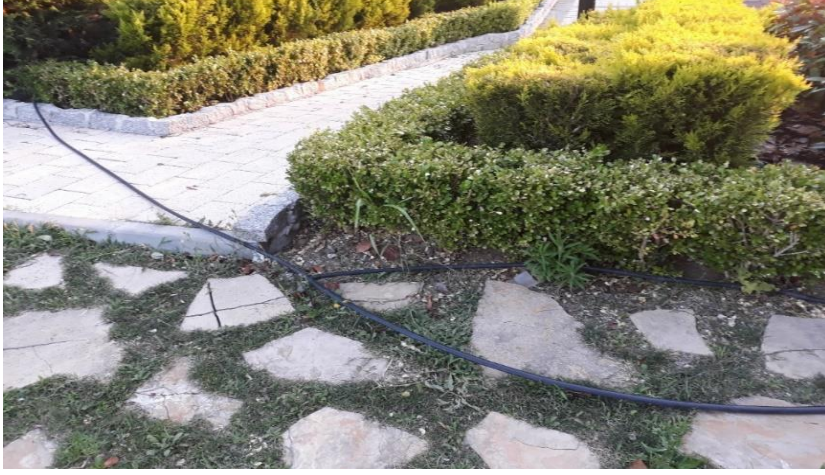
Şekil 4.63. Şehit Kıvanç Kaşıkçı Parkı sulama sistemi geçişi
