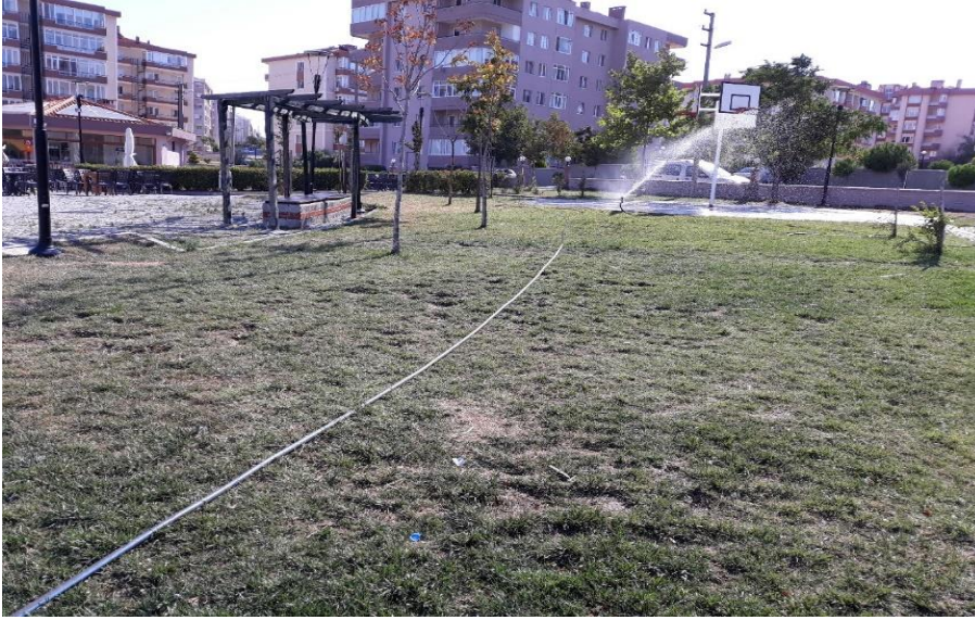
Şekil 4.25. Esen Parkın mevcut sulama sistemi
