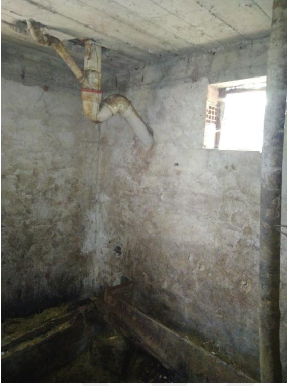
Şekil 4.14. Zonguldak Çaycuma Serdaroğlu Köyü'nde risk değerlendirmesi yapılan ahırın ikinci kısmındaki yemlikler ile ev gider sistemi
