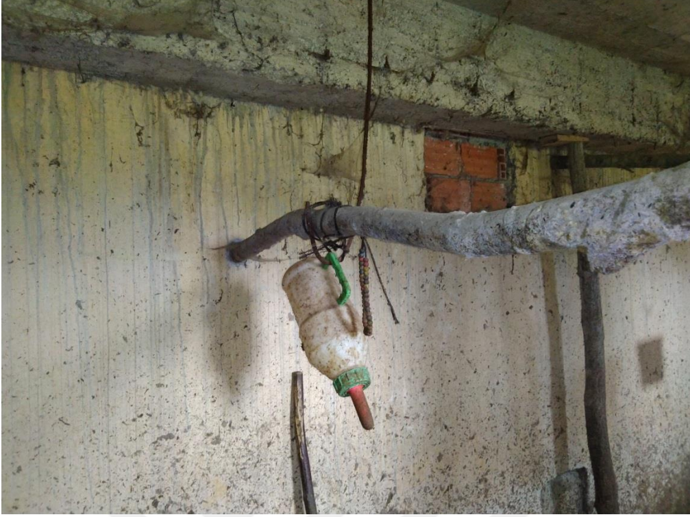
Şekil 4.17. Zonguldak Çaycuma Serdaroğlu Köyü'nde risk değerlendirmesi yapılan ahırın duvarları ve buzağılar için kullanılan biberon
