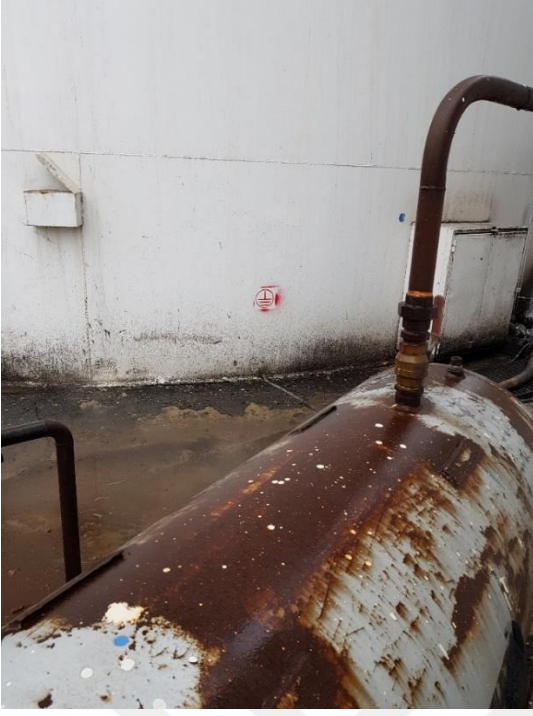
Şekil 4.32. Ham yağ tanklarının yanında uyarı ve önlem işaretlerinin bulunmaması
