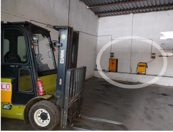
Şekil 5.6. Elektrikli transpaletlerin şarj istasyonlarından bir görüntü
