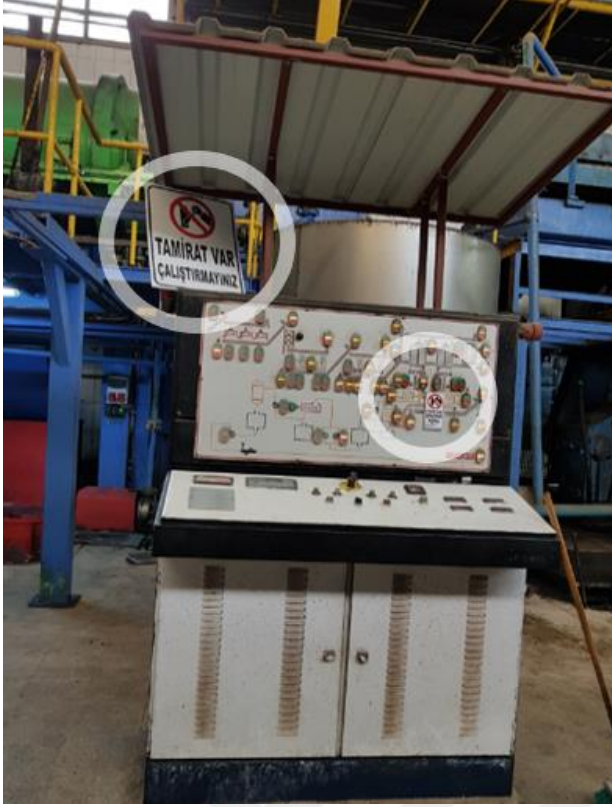
Şekil 5.4. Yağ firması bakım sırasında Loto sistemi ile güvenli elektrik kontrolü
