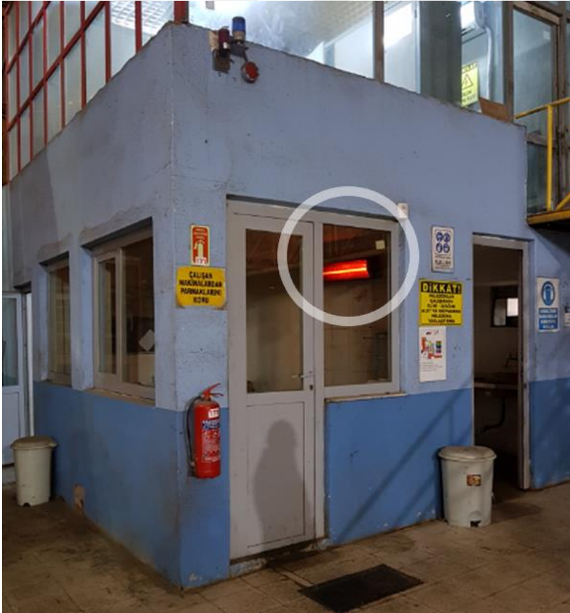
Şekil 4.15. Açık unutulmuş ısıtıcıların görüntüsü
