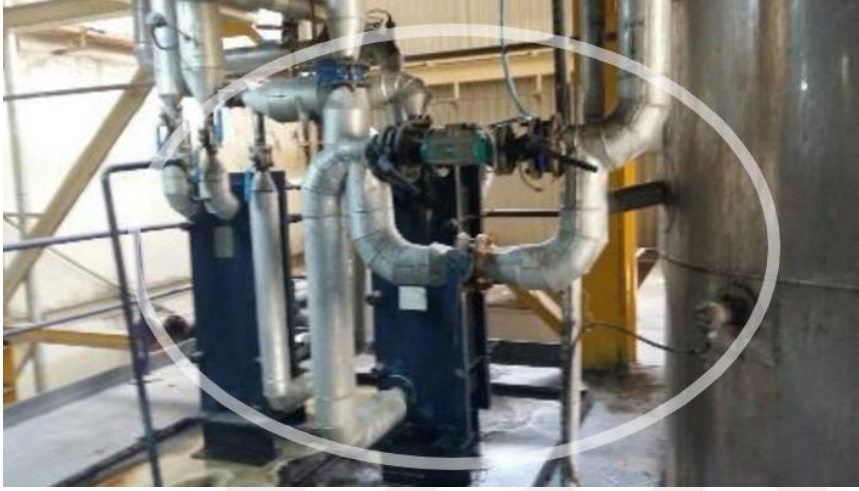
Şekil 4.29. Rafinasyon bölümünde boru sistemleri görüntüsü
