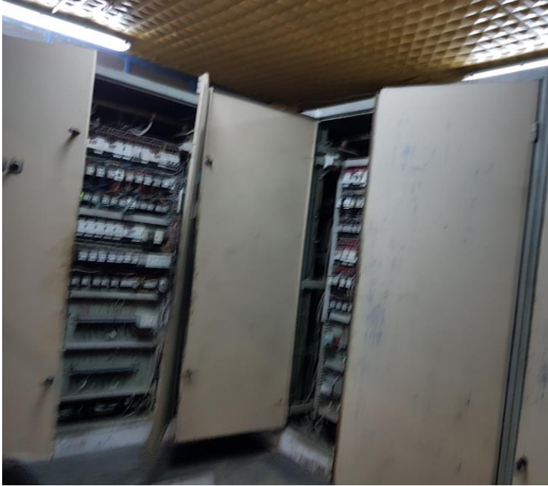
Şekil 4.16. Presleme ünitesinde açık bırakılan elektrik panoları resmi
