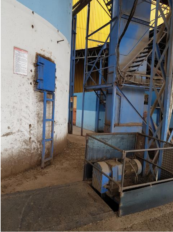
Şekil 4.8. Silo yakınlarında güç sistemlerinin görüntüsü
