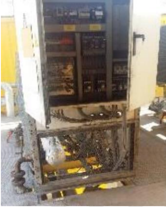
Şekil 4.31. Dış sahada açık unutulmuş bir elektrik panosu
