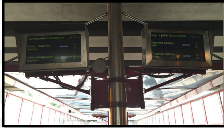
Şekil 4.14: Kayseri tramvay istasyonu akıllı uyarı sistemi
