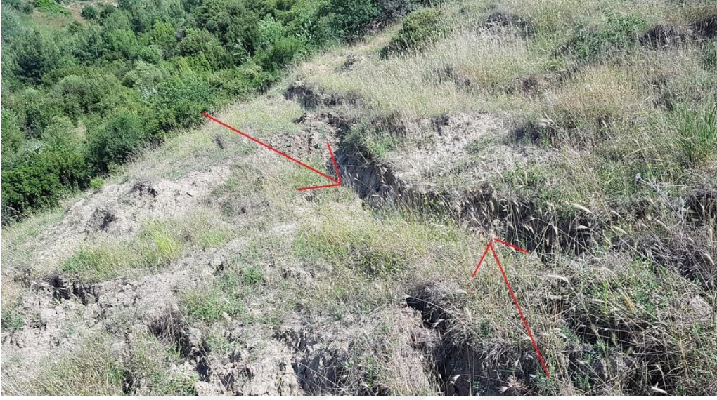
Şekil 4.10. Çalışılan alandan 18.06.2019 tarihinde arazide çatlakların belirgin olarak görülmekte
