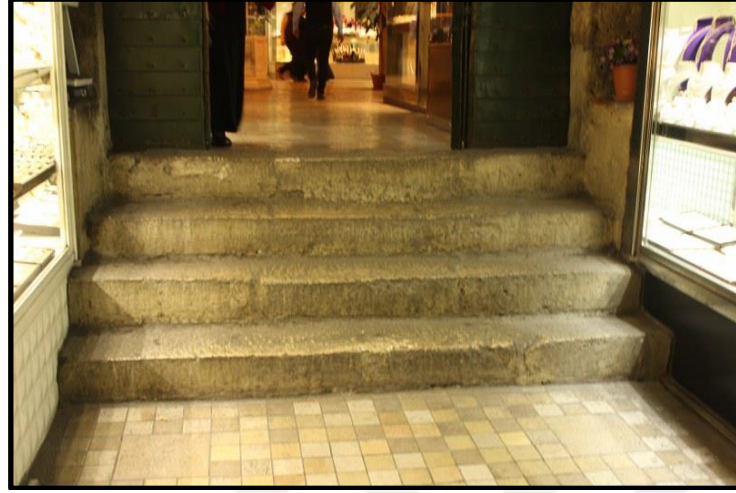
Şekil 6.15: Rampa eksikliği kaynaklı problem örneği
