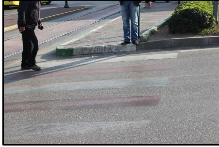
Şekil 6.18: Rampa eksikliği kaynaklı problem örneği
