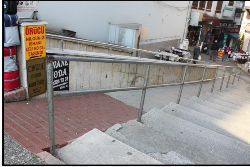
Şekil 6.25: Yanlış rampa uygulamaları kaynaklı problem örneği
