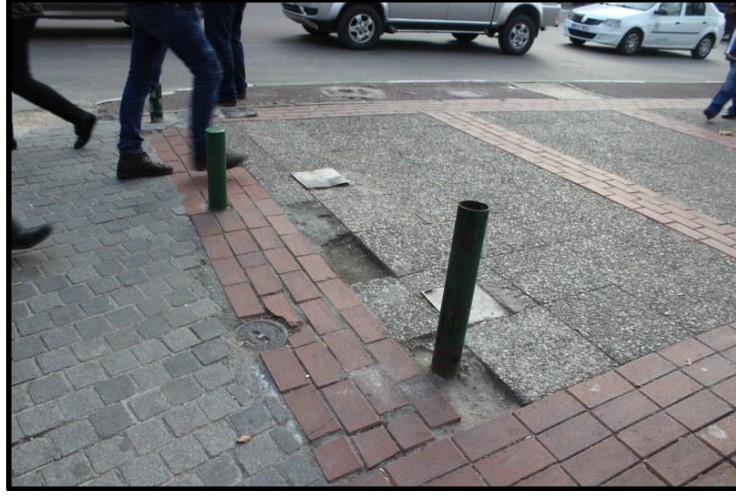
Şekil 6.9: Zemin malzemesi tahribatı kaynaklı problem örneği
