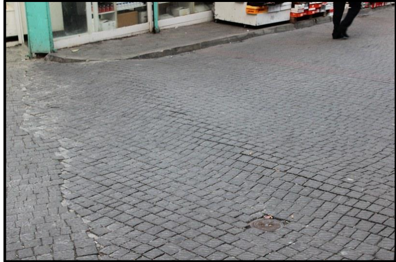
Şekil 6.2: Yanlış malzeme seçimi kaynaklı problem örneğı
