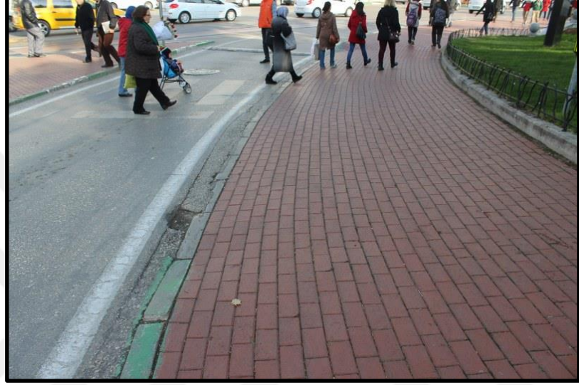
Şekil 6.11: Kaldırım kenarları kaynaklı problem örneği
