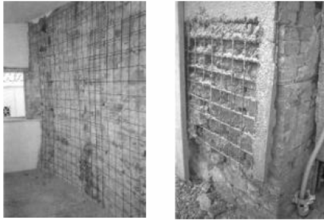
Fotoğraf 2.1. Çelik tel ile güçlendirilmiş duvarlar [5]
