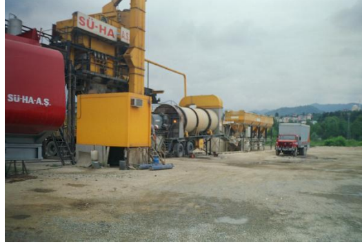
Şekil 3.3. Bir Asfalt Plenti
