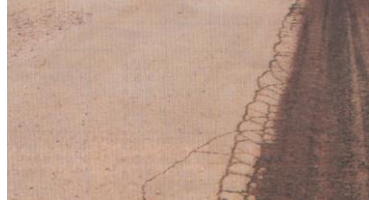
Şekil 3.29. Orta Şiddette Kenar Çatlağı (KGM, 2000)
