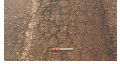
Şekil 3.30. Yüksek Şiddette Kenar Çatlağı (KGM, 2000)
