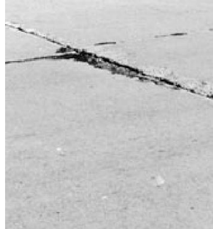
Şekil 4.20. Enine Derz Çatlağı (Transportation Information Center, 2002)
