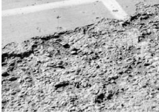
Şekil 4.14. Yol Yüzeyinde Meydana Gelen Soyulmalar (Transportation Information Center, 2002)
