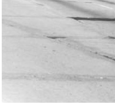
Şekil 4.10. Büzülme Çatlakları (Transportation Information Center, 2002)
