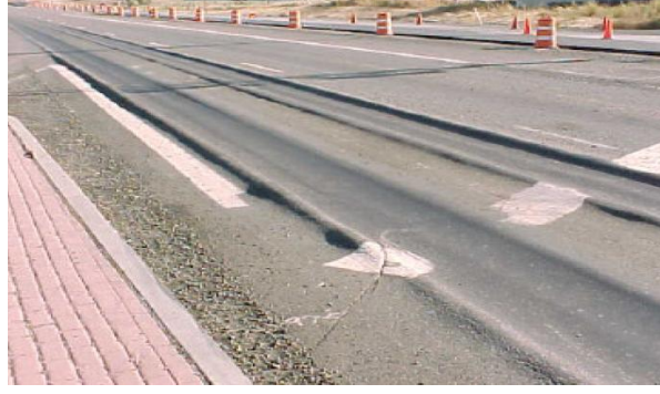
Şekil 3.17. Tekerlek İzi ve Oluklanma Oluşumu (California Department of Transportation, 2001)
