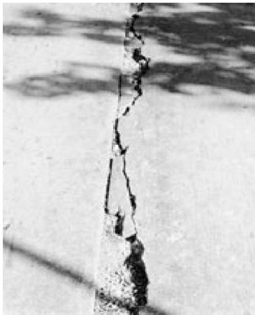
Şekil 4.19. Boyuna Derz Çatlağı (Transportation Information Center, 2002)
