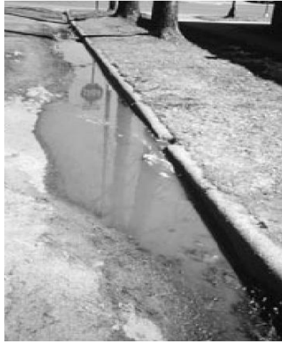
Şekil 4.16. Yol Yüzeyindeki Su Birikintileri (Transportation Information Center, 2002)
