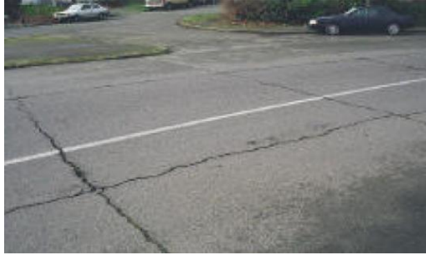
Şekil 3.32. Yansıma Çatlakları (Terzi, 2004)
