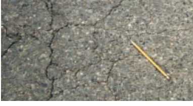
Şekil 3.28. Hafif Şiddette Kenar Çatlağı (KGM, 2000)
