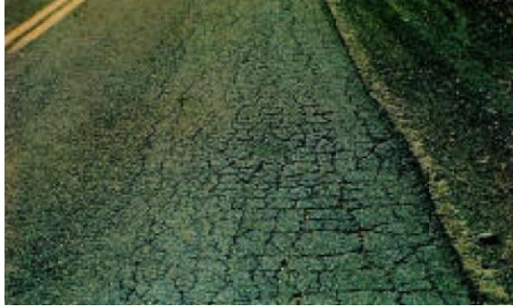
Şekil 3.27. Timsah Sırtı Çatlak (KGM, 2000)
