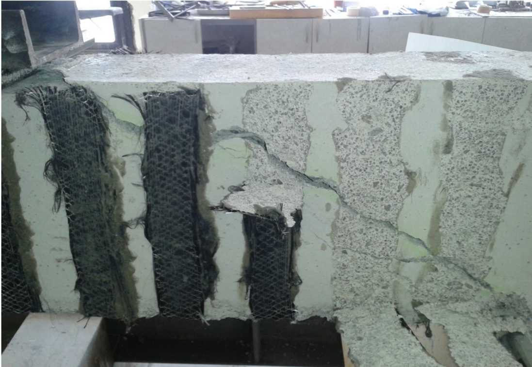
Şekil 8.13. GK3 kirişinde göçme sonucu oluşan kesme çatlakları
