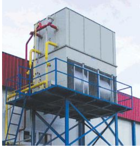
Şekil 2.13 Tesis Dışına Yerleştirilen Evaporatif Kondenser
