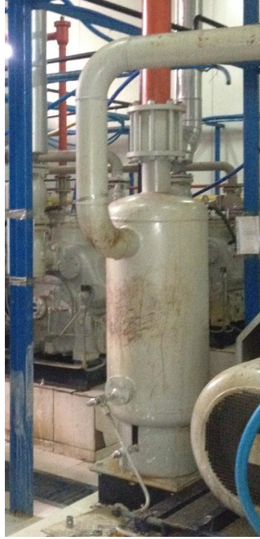
Şekil 2.9 Tesiste Bulunan Yüksek Basınç Kompresörüyle Çalışan Yağ Ayırıcısı
