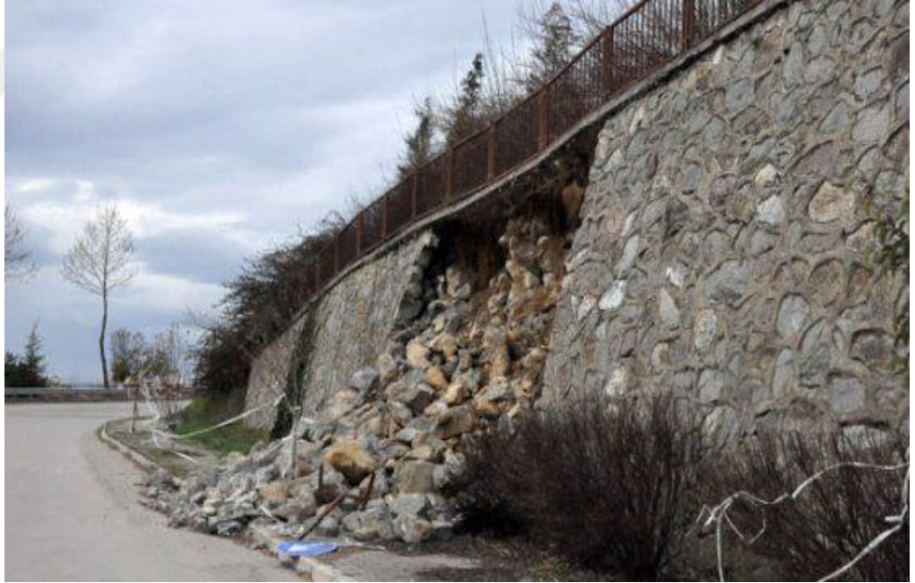
Şekil 1.2. Yıkılmış bir istinat duvarı örneği
