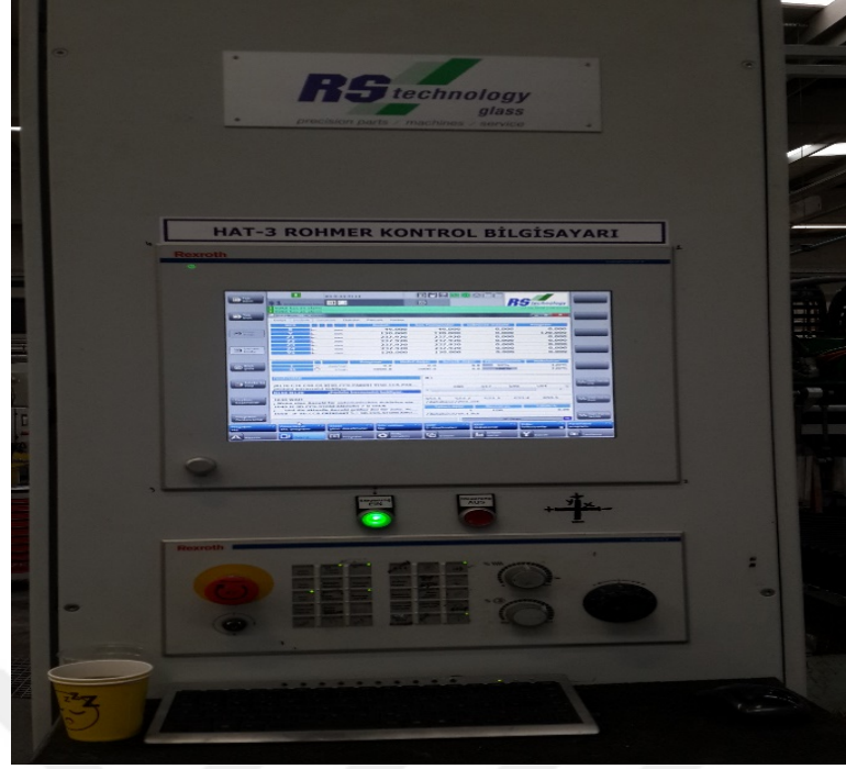
Şekil 5.2. Rohmer kontrol paneli.
