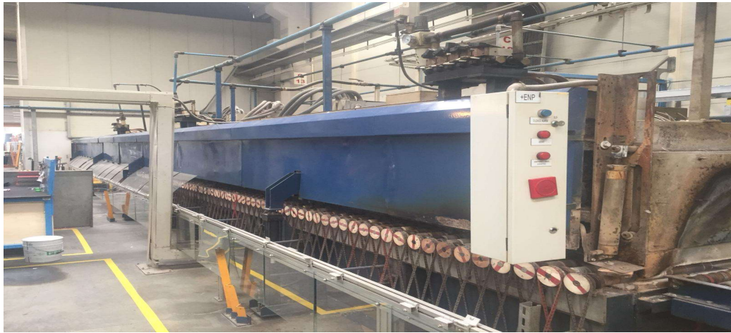
Şekil 6.3. Temperleme Hattında Fırın Kısımının Genel Görünümü
