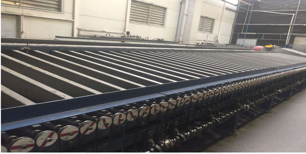
Şekil 6.8. Cooling Bölümünün Genel Görünümü
