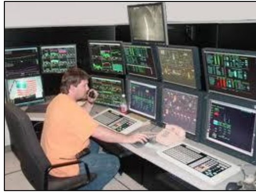
Şekil 8.1 Merkezi kontrol odası.
