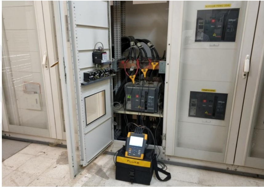
Şekil 4.1. Doğu TR-3 Trafo Merkezi Enerji Kalite Ölçümü
