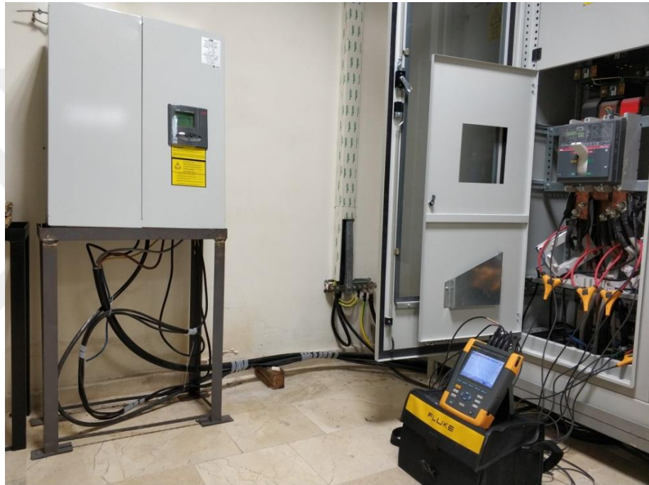
Şekil 4.21. Mühendislik Fakülte Binası Elektrik Ana Dağıtım Panosunda Enerji Kalite Ölçümü
