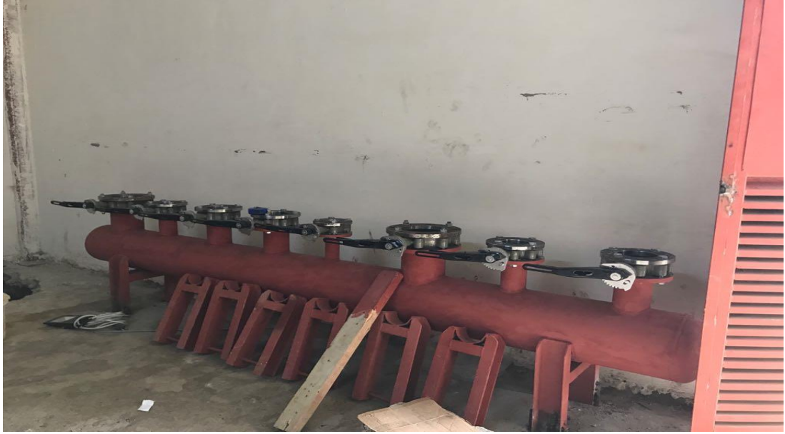
Şekil 4.4. Otel ana ısıtma dönüş kollektörü
