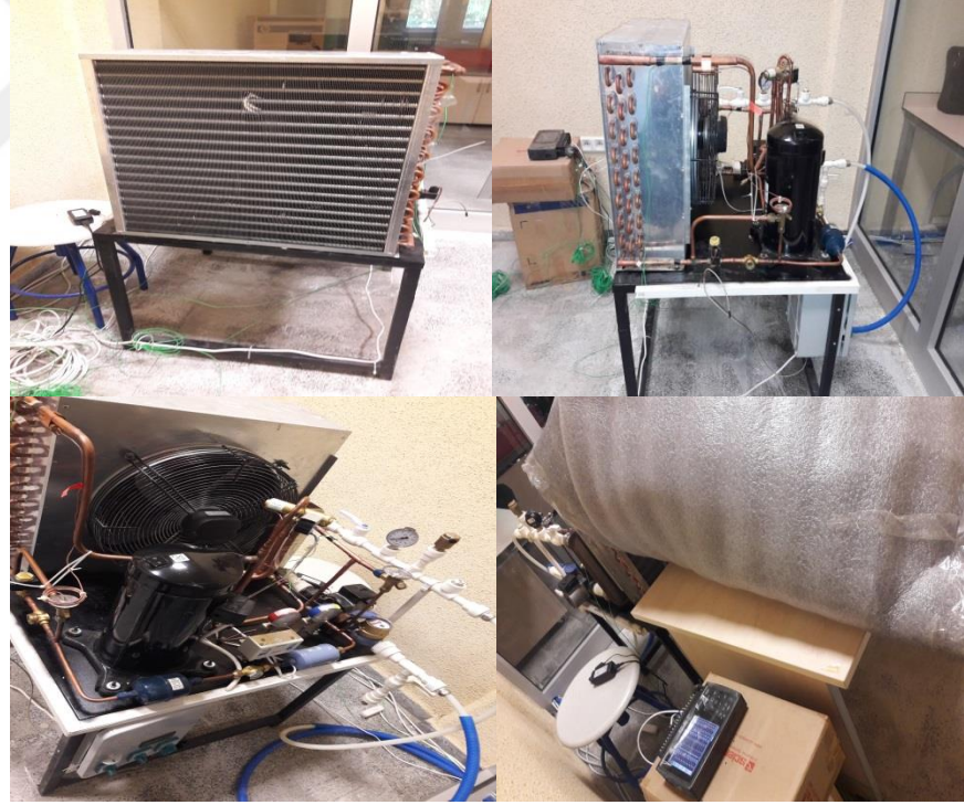
Şekil 3.1. Deneysel ısı pompası sisteminin farklı açılardan görüntüsü
