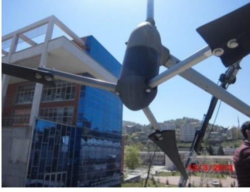
Şekil B.5 Rüzgâr türbini.
