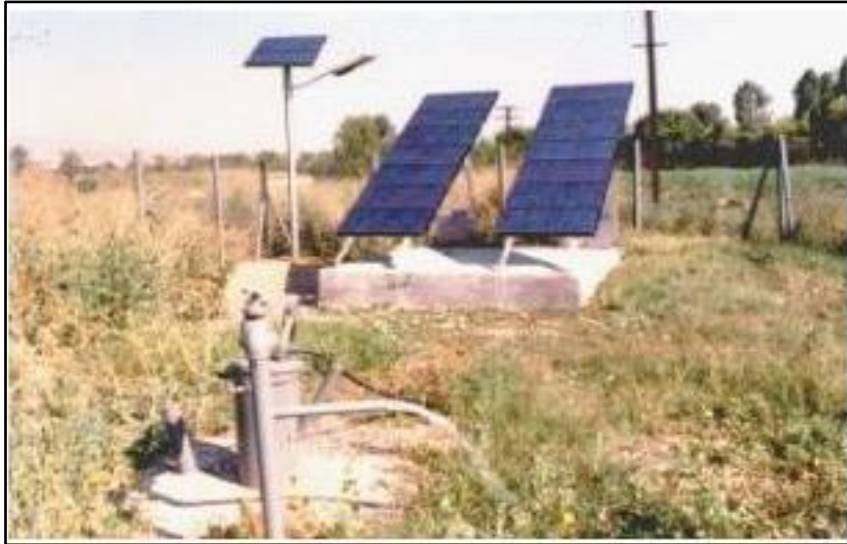
Şekil 1.9 Güneş enerjili sulama sistemi.
