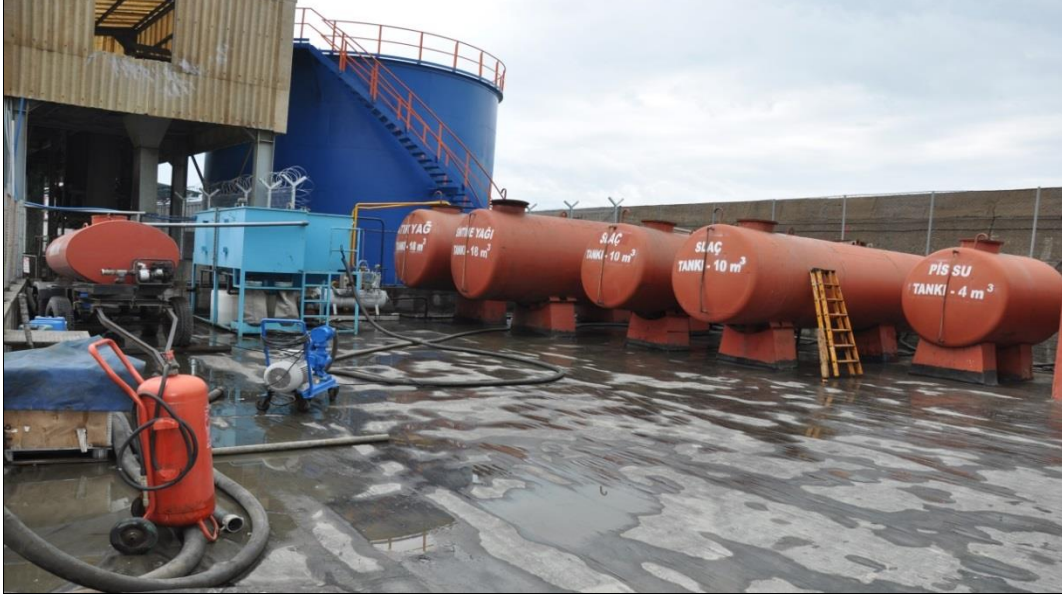
Şekil 5.23. İnebolu Limanı Atık Kabul Tesisi Genel Görünümü.
