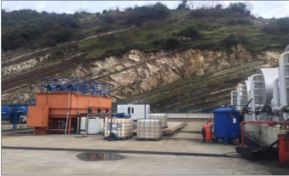
Şekil 5.12. Eren Limanı Atık Kabul Tesisi Genel Görünümü.
