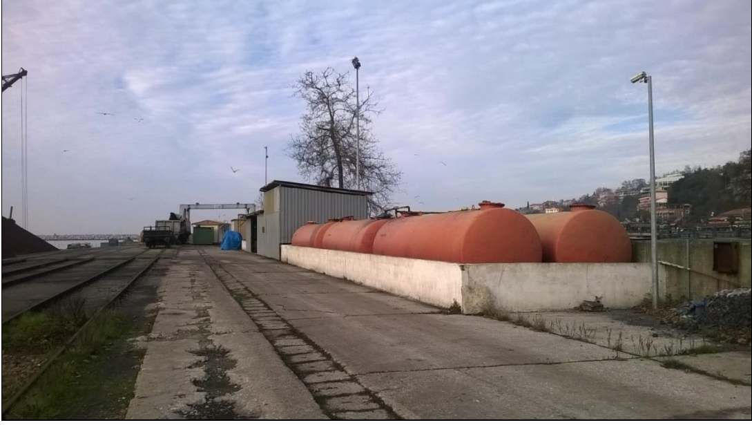
Şekil 5.15. TTK Limanı Atık Kabul Tesisi Genel Görünümü.
