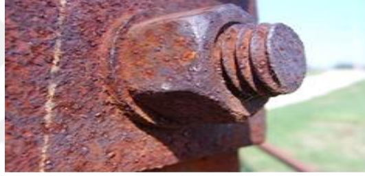
Şekil 1.1 Korozyona uğrayarak aşınmış bir malzeme [1].
