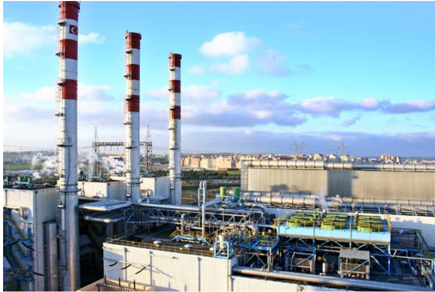
Şekil 1.8 Doğa Enerji Esenyurt Termik Santrali [12].
