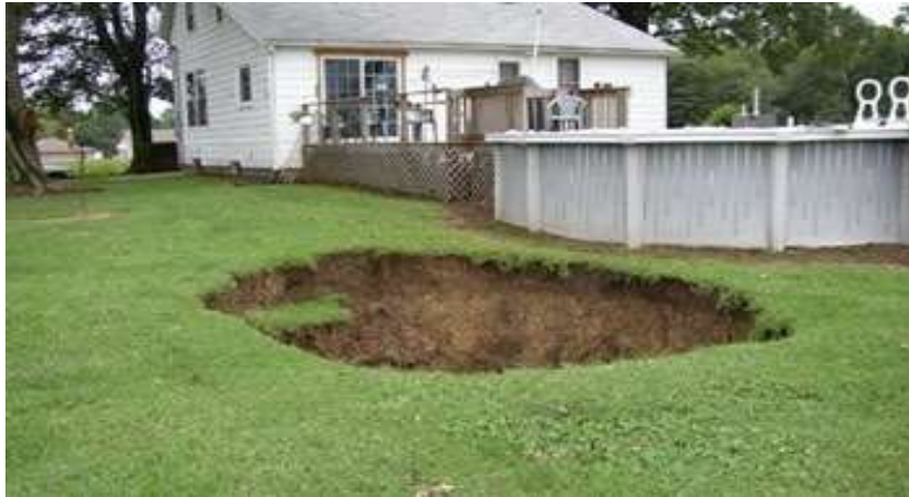
Şekil 4.3 Tasman sonucu yeryüzünde oluşan hasar (URL-10)
