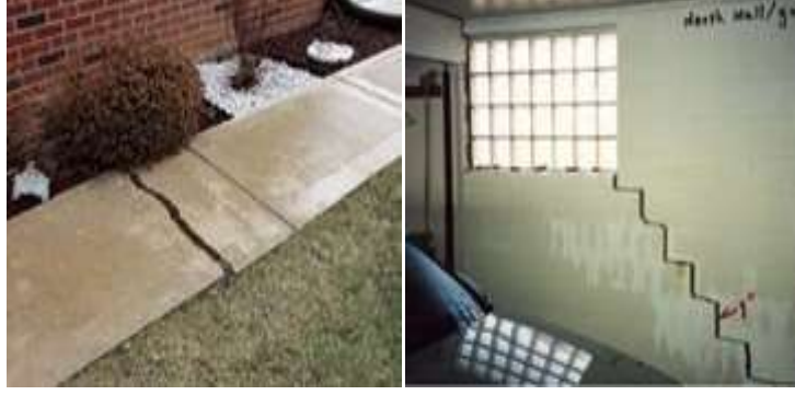
Şekil 3.2 Kaldırım ve duvarda görülen çatlaklıklar (URL-4)
