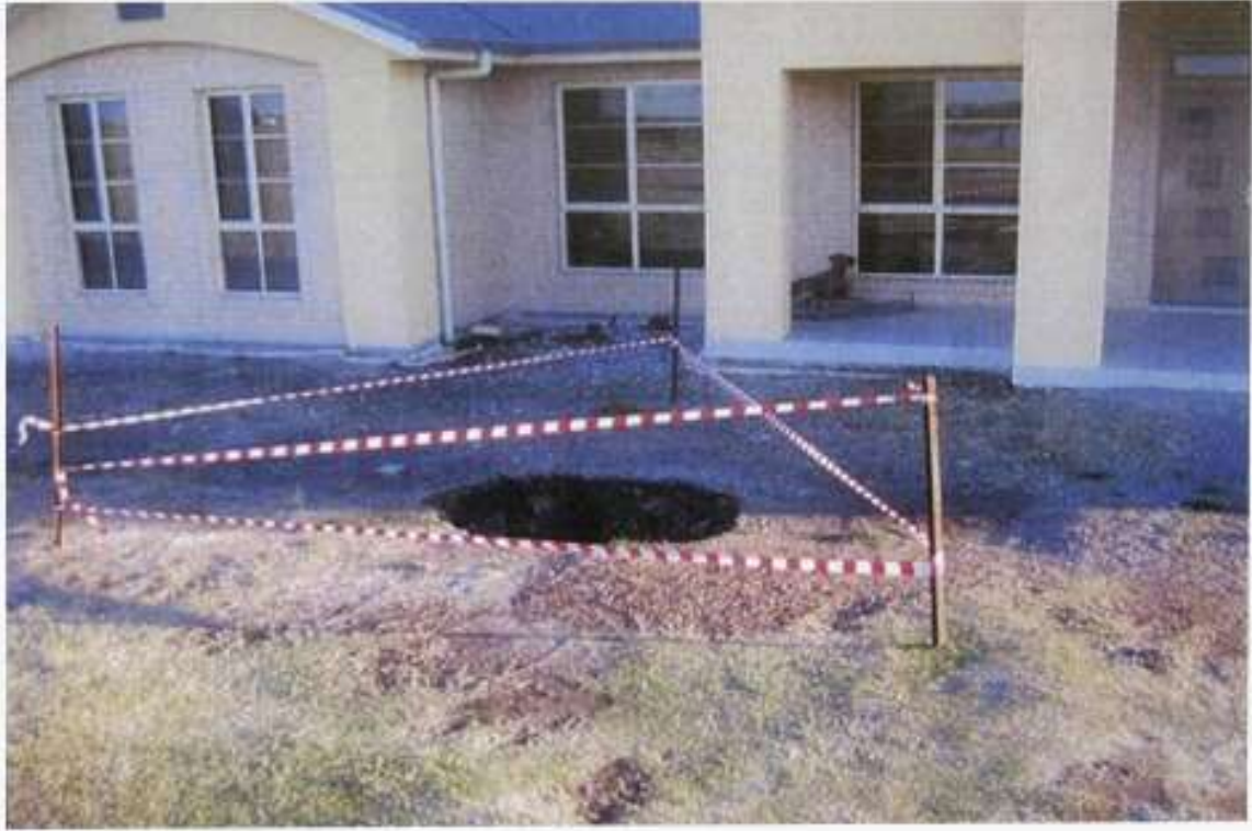
Şekil 4.5 Tasman sonucu yeryüzünde oluşan hasar (URL-10)
