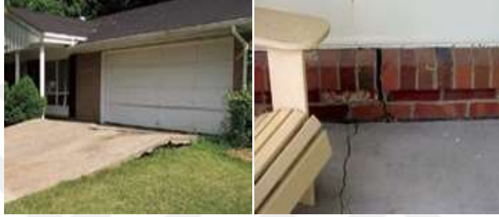
Şekil 3.3 Garaj girişi ve Bina köşesinde görülen çatlaklar (URL-4)
