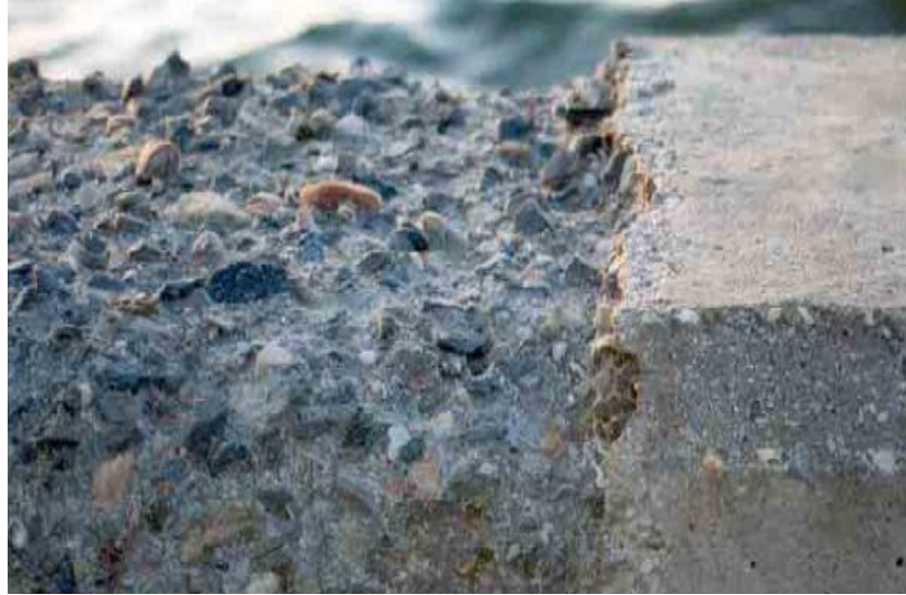
Şekil 2.10. Deniz suyu etkisindeki liman betonunun görünümü
