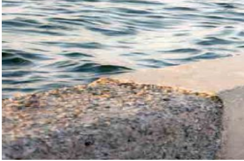
Şekil 2.9. Deniz suyu etkisindeki liman betonunun görünümü
