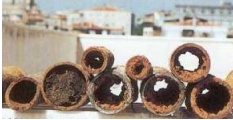
Şekil 1.1 Atık Yağlar Nedeniyle Tıkanmış Boruların Kesiti
