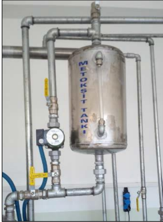
Şekil 4.21. Sirkülasyon pompası ve metoksit tankı
