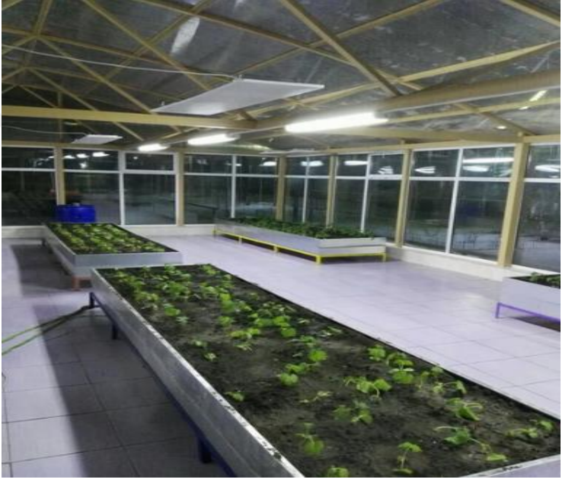
Şekil 2.11. Infrared panel ısıtıcıyla sera ısıtılması
