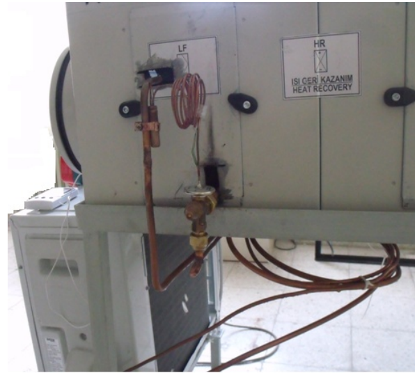
Şekil 7.3.b. Soğutma grubu yan görünüşü.
