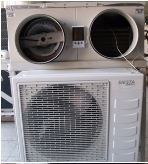
Şekil 7.3.a. Soğutma grubu ön görünüşü.
