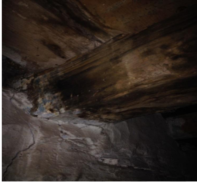
Şekil 5.4. Döşeme kirişi bağlantı noktası deformasyonu.
