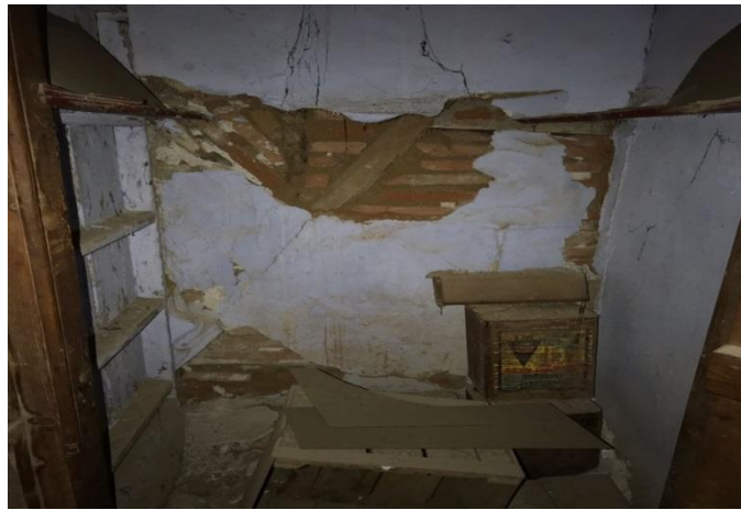
Şekil 5.9. Dış duvar düzlem dışı deformasyonu.
