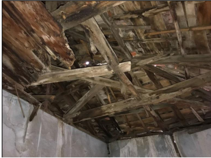
Şekil 5.2. Deforme olmuş çatı taşıyıcıları.
