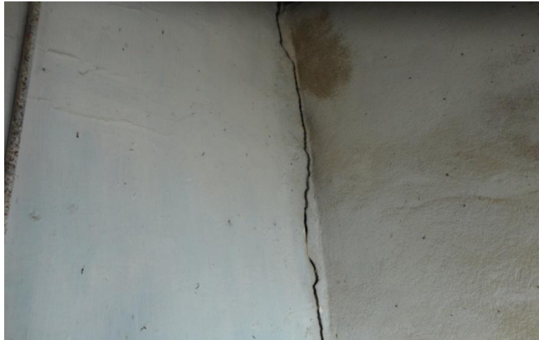
Şekil 5.5. Düşey taşıyıcı duvar ayrışması.
