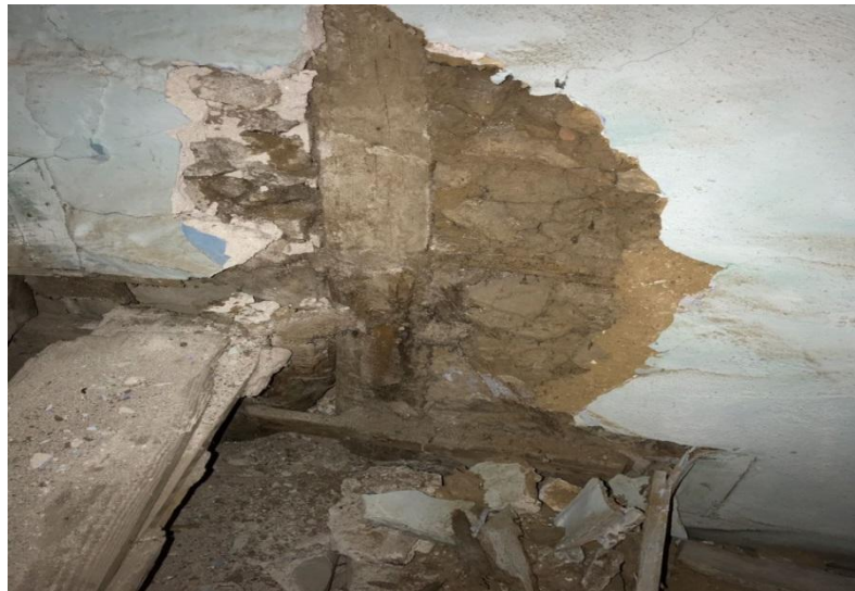
Şekil 5.7. Düşey taşıyıcı kolon düğüm noktası deformasyonu.
