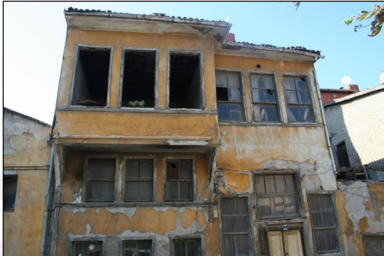
Şekil 5.10. Yapı dış görünüş risk durumu.
