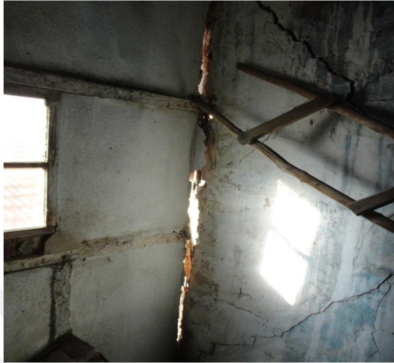
Şekil 5.6. Köşe duvarlarında oluşan ayrışmalar.
