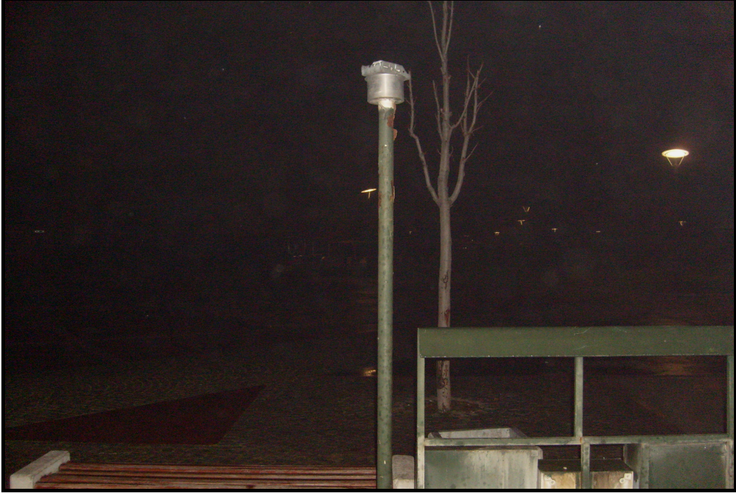
Şekil 5.32 Altınpark’ta vandalizmden dolayı kırılmış bir aydınlatma örneği (Fotoğraf: Fatih Yeniöglü 2009).
