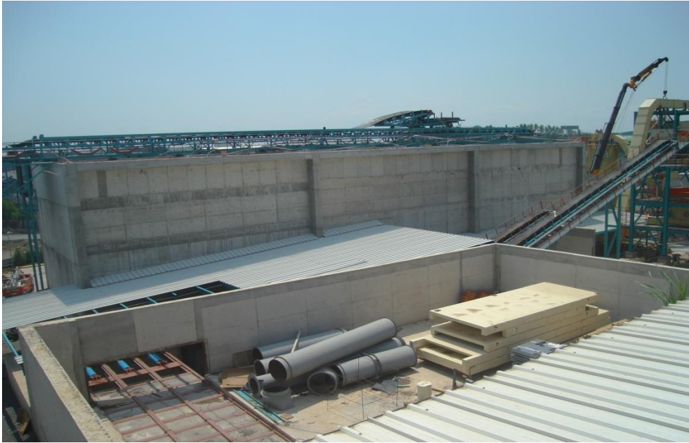
Şekil 13: Yongaların depolandığı beton silo.
