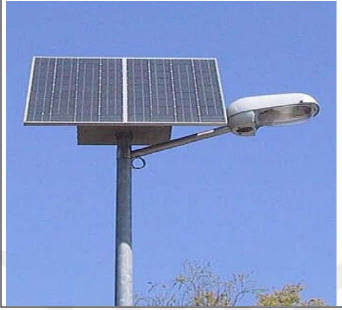
Şekil 4.18: Fotovoltaik sokak lambası
