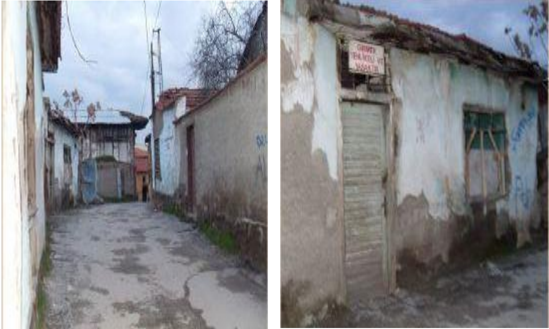
Şekil 5.16. Çürümüş Ahşap Saçaklar ve Aktarılması Gereken Çatılar ve Statik Sorunu Olan ve Tehlike Yaratan Bir Yapı 285
