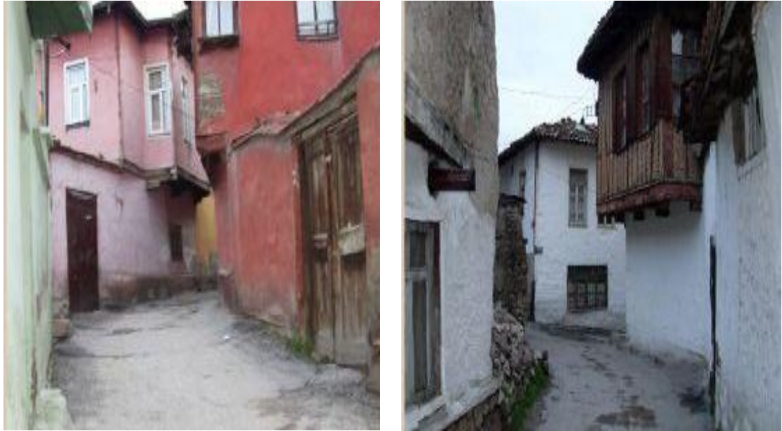
Şekil 5.15. Dökülmüş Sıvalar ve Çürümüş Ahşap Çıkma 284
