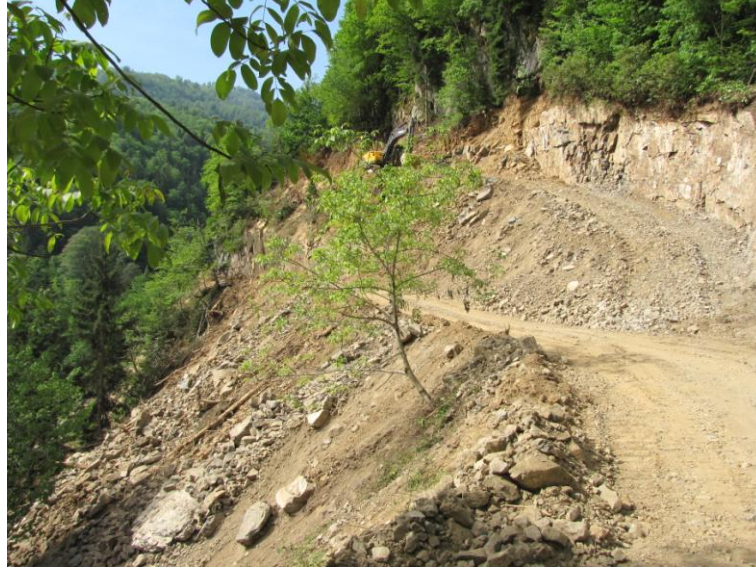
Şekil 11. Yol çalışması ve tahribatından bir görünüm (Düzenli-Camili köyü arası)
